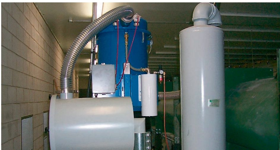
Le système de récupération des particules métalliques
