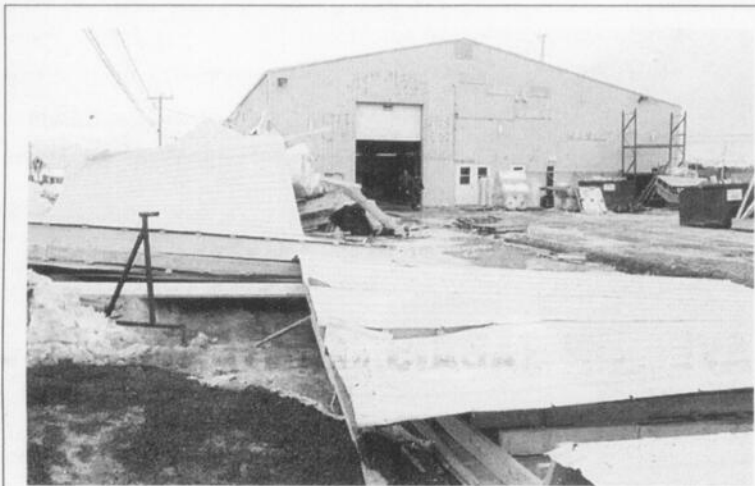
ENTREPÔT - Le vent a jeté par terre l'entrepôt en construction d'une quincaillerie de Métabetchouan-Lac-à-la-Croix.
