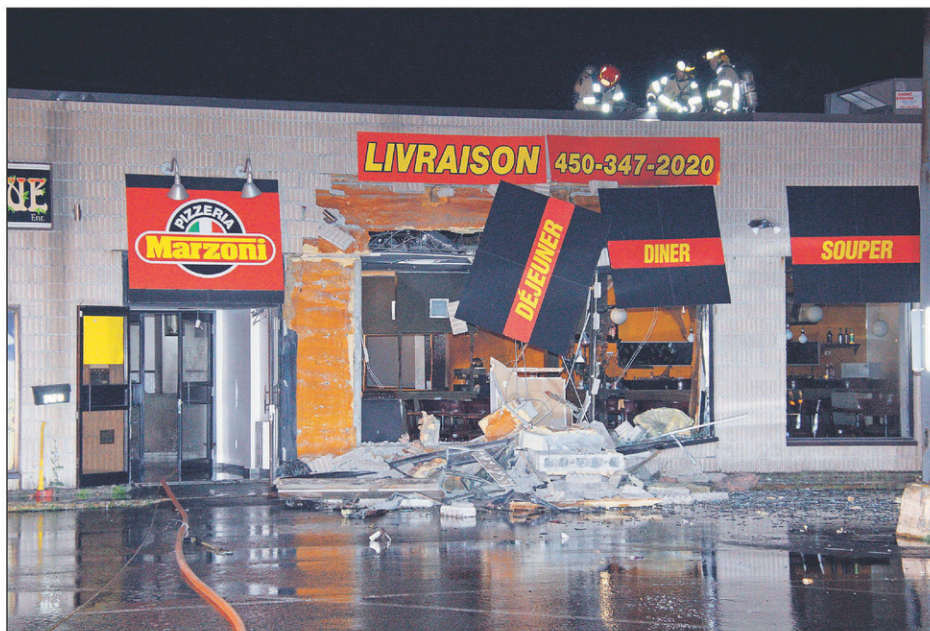
La déflagration a causé des dommages à l'avant et à l'arrière du bâtiment commercial de la rue Saint-Jacques.
