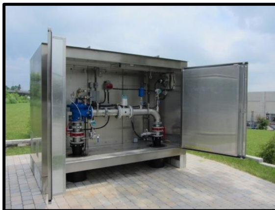
Figure 12. Poste de contrôle de pression hors-sol (Ville de Québec)
