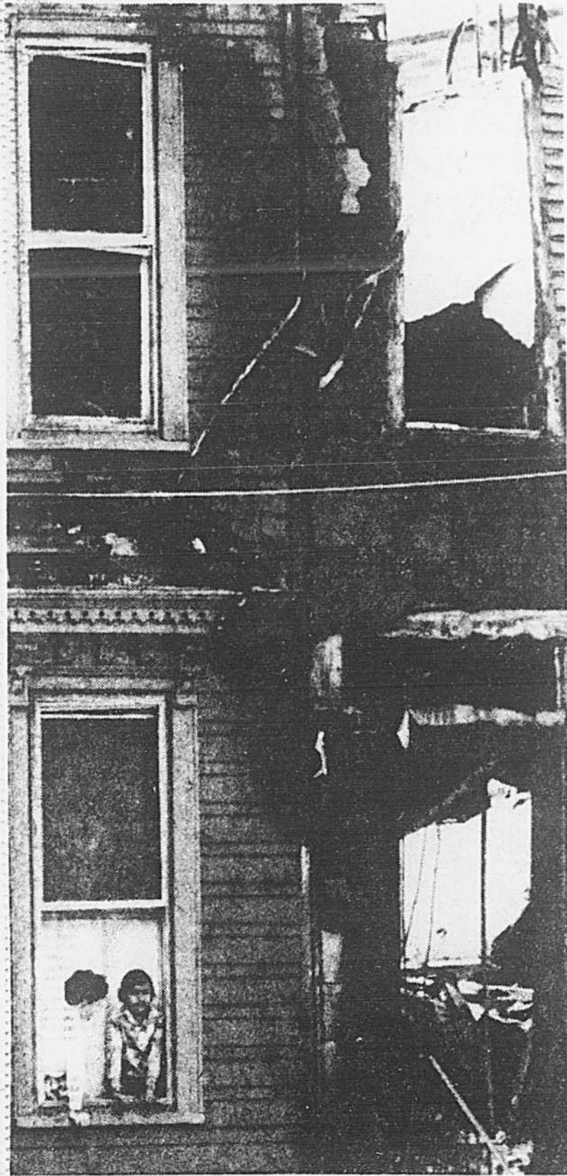
Des gens persistent encore à habiter leur logement en dépit des ruines qui les entourent.
