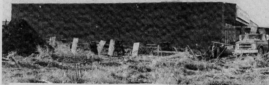
Un nouveau magasin de la Société des Alcools du Québec verra prochainement le jour à Valleyfield. Il sera situé sur le Boulevard Mgr Langlois à proximité de la succursale de Distribution aux Consommateurs. Les travaux ont débuté au cours de la semaine dernière et le magasin devrait ouvrir ses portes très prochainement. (Photo Le Soleil Jacques Smith)
