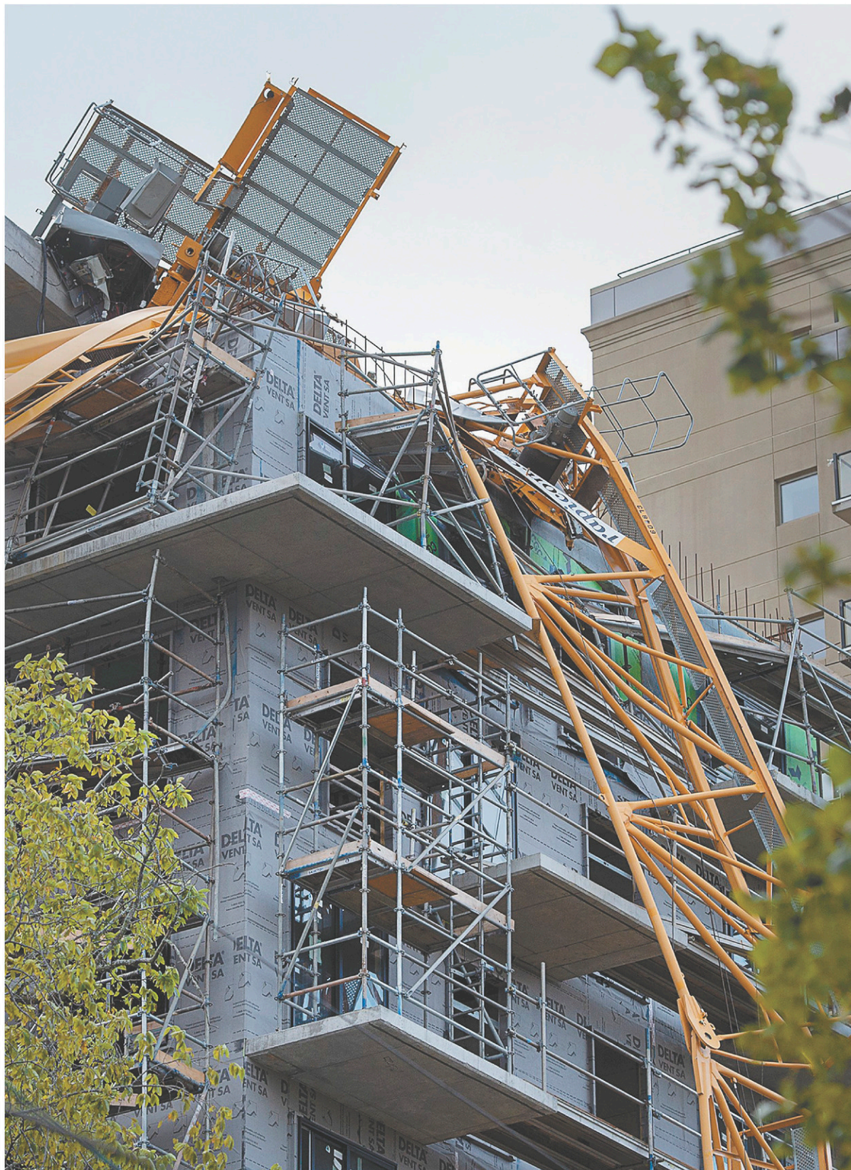
Une grue s'est affaissée sur un chantier de construction à Halifax dimanche. On ne rapporte aucun blessés.
