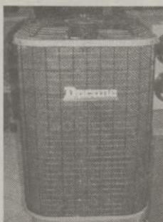
La thermopompe est utilisée dans un système bi-énergie.
