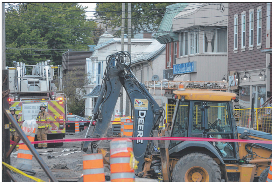
À deux reprises, une fuite de gaz a amené les pompiers à intervenir sur le chantier de la 1 re Rue, à Iberville.
