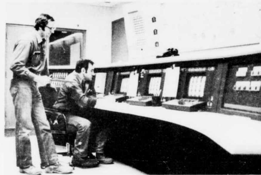
La salle de contrôle du Centre de calcination. Maurice Bergeron et Michel Jean surveillent les tableaux reliés aux trois calcinateurs.
