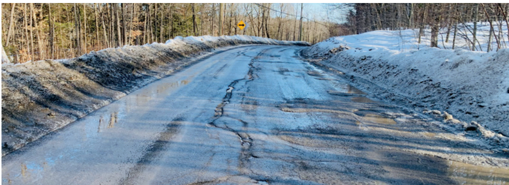
Fissure de type lézarde, telle que décrite à la figure 2
