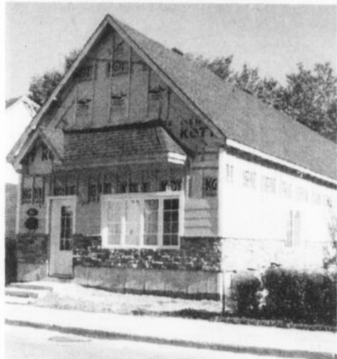
Malgré des avis d'infraction, le propriétaire de la résidence a récemment installé une partie du revêtement extérieur. (Photo : Pénélope Clermont)
