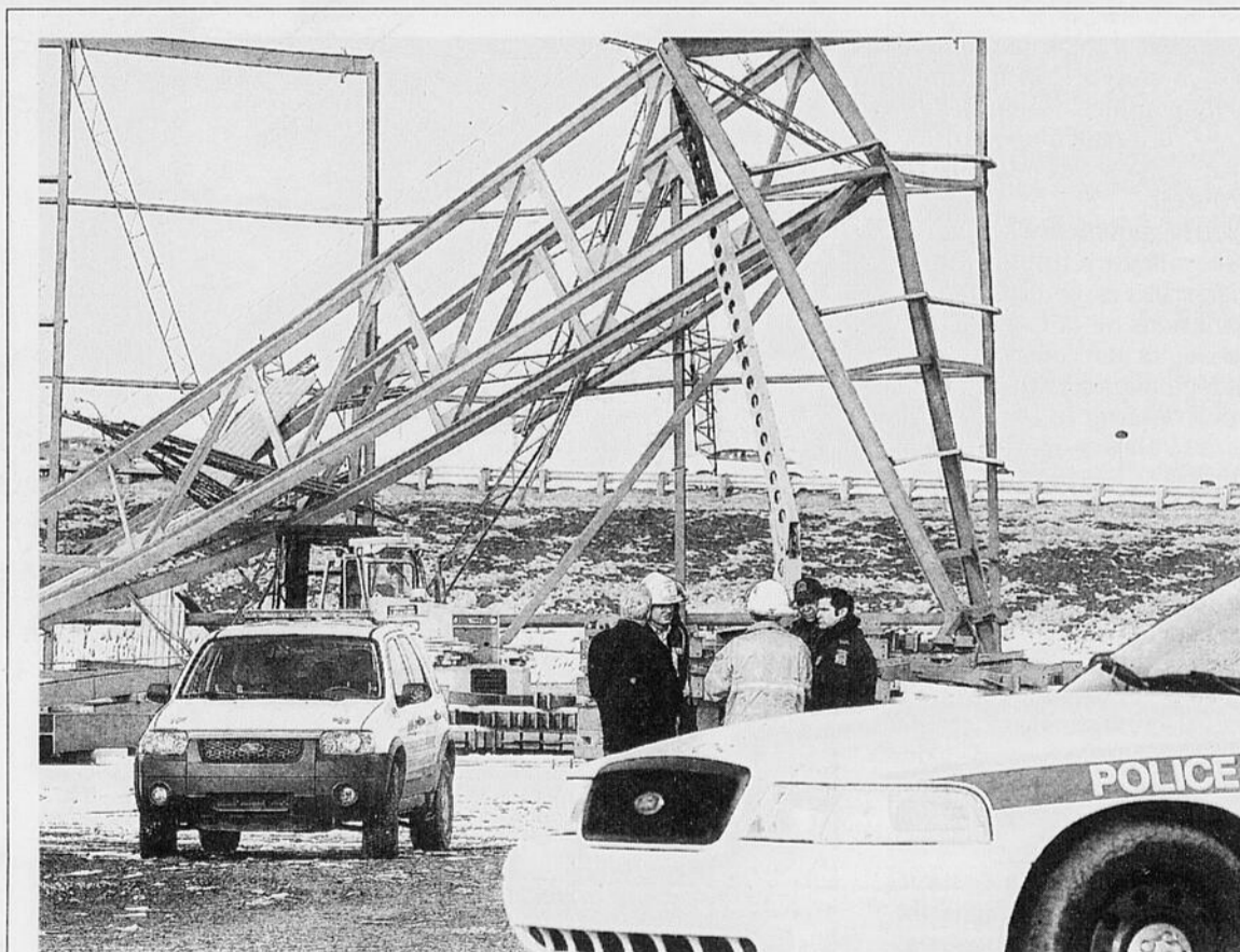
EFFONDREMENT - Huit ouvriers juchés à 40 pieds du sol ont eu la frousse de leur vie, lundi après-midi, quand la structure d'acier qui les soutenait s'est affaissée sous eux, les précipitant dans le vide. Ils s'affairaient alors à monter une partie du futur centre d'entraînement du Canadien de Montréal, dans le quartier Dix30 de Brossard. Les ouvriers de la firme Structures de Beauce commencent la construction du toit d'un bâtiment devant abriter un terrain de soccer intérieur. Cette bâtisse est voisine des patinoires du Canadien de Montréal. Selon les pompiers, les travailleurs posaient le revêtement d'acier sur la structure quand l'échafaudage s'est brusquement effondré, sans aucun signe avant-coureur.
