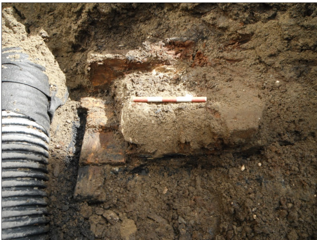
Photo 18. Drain CeEt-80-22E3 obstrué par une pierre et du mortier, vue vers le sud (CeEt-80-17-NUM1-172)
