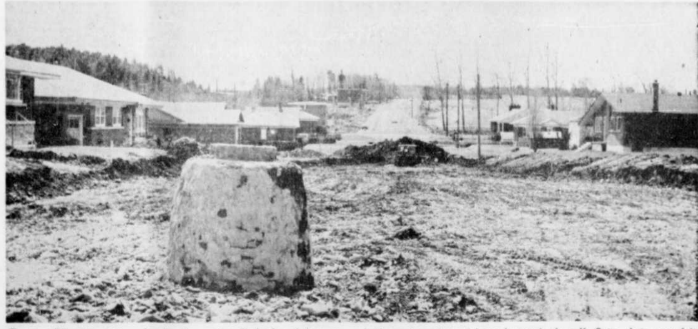
Travaux d'élargissement. — La dernière section du boulevard Jacques-Cartier (entre la rue Vermont et la rue Beckett) sera élargie comme les précédentes. On avait, l'automne dernier, élargi la section de Prospect à Vermont, section qui longe le terrain de golf. Cette photo nous fait voir qu'on a dû baisser le niveau de la rue de plusieurs pieds quand on voit au premier plan la bouche d'égout à découvrir.
