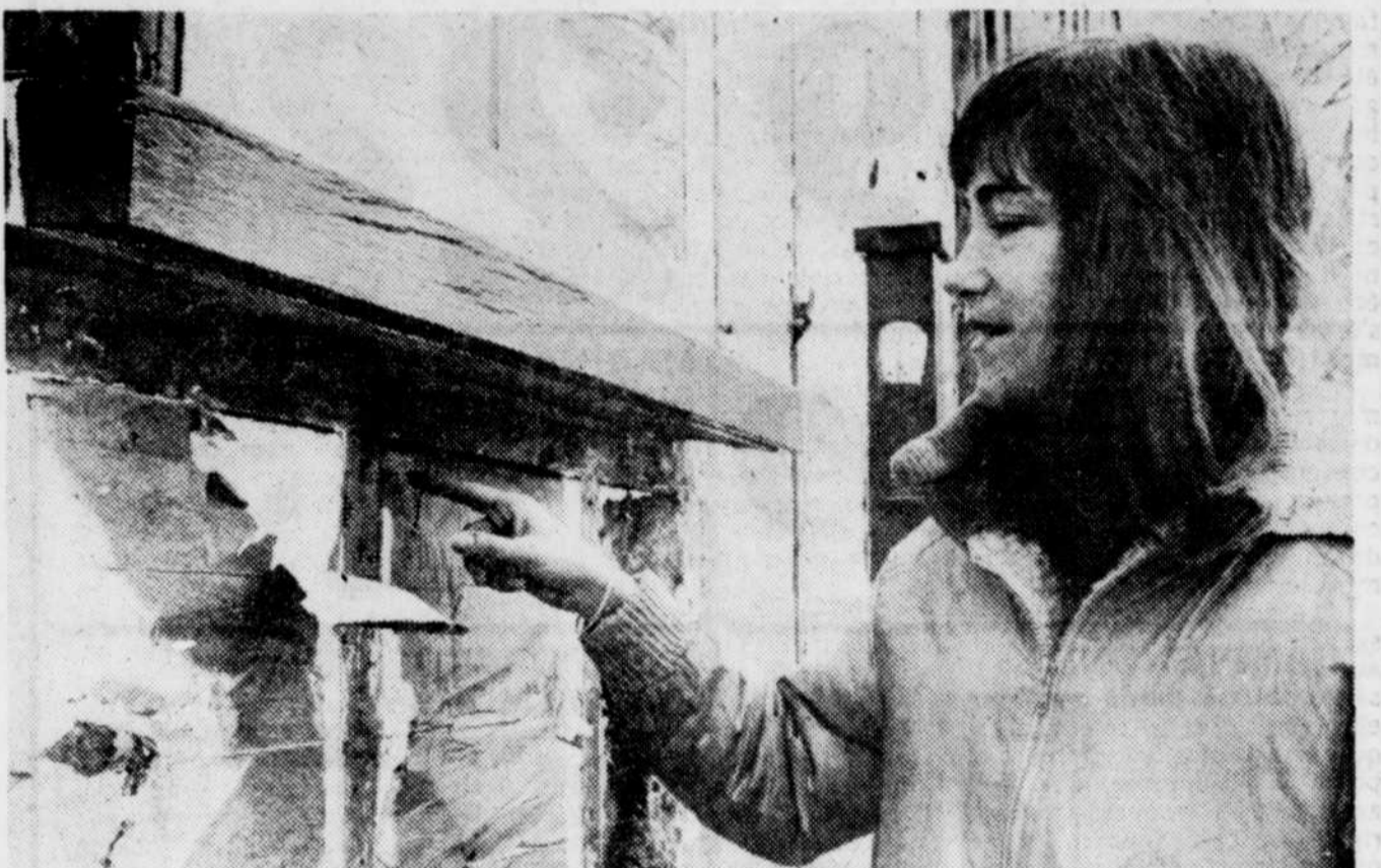
Mira Falardeau montre qu'une fois séchée la mousse isolante d'urée formol a rétréci laissant l'air s'infiltrer dans la maison comme autrefois.
