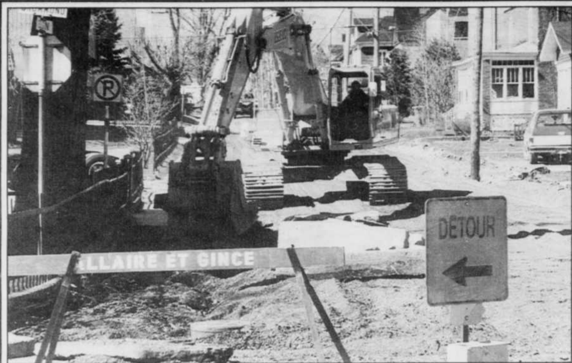
Le chantier de la rue Elgin a commencé hier et se poursuit pour six semaines.
