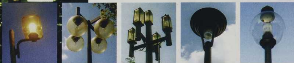
Des luminaires à proscrire parce qu'ils laissent échapper de la lumière vers le haut.
