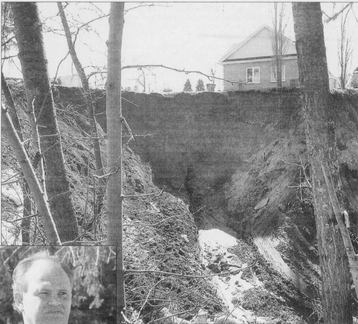
AU FOND - Cette photo prise au fond du ravin montre clairement les risques d'affaissement qui guettent la résidence du 1135, rue Paul-Omer Gagnon, à La Baie.
