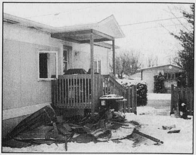
Photo La Tribune, Pierre Saint-Jacques Un incendie a ravagé le toit et l'intérieur d'une maison mobile, rue Laperle, à Rock Forest, avant l'aube hier. Cet incendie pourrait être la conséquence d'un feu de friture, survenu la veille, vers 17 h 15. La maison était inoccupée lors du second incendie.
