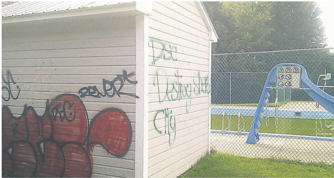
Des graffitis sont apparus sur les murs du chalet du parc.
