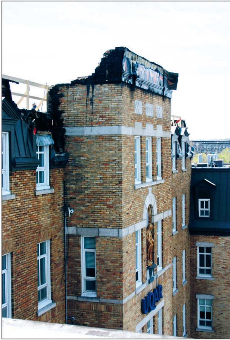
L'incendie qui a détruit le toit et l'entre-toit du pavillon central a causé des dégâts qui se comptent en millions de dollars. — PHOTO CARL THÉRIALULT
