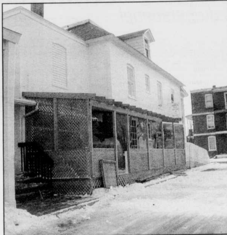
La terrasse latérale extérieure sera démolie pour permettre d'agrandir par l'intérieur. photo Michel Saint-Jean
