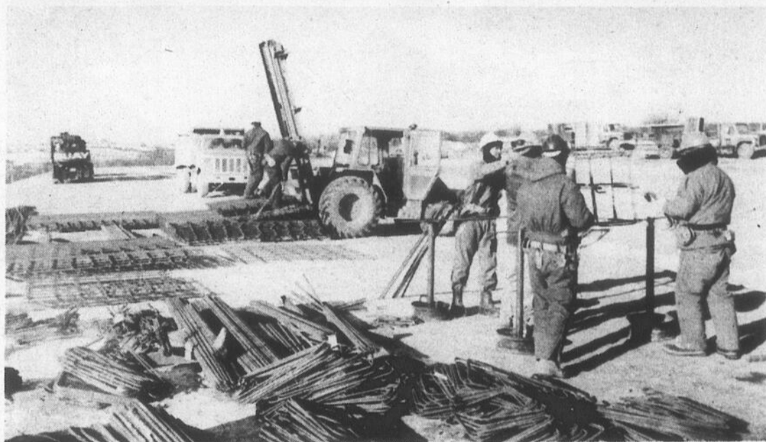
Malgré le froid glacial de vendredi sur le chantier de Tafisa, la vingtaine d'ouvriers réalisait les opérations de coulage de béton ainsi que la construction de formes et armatures. Ces travaux s'inscrivent dans le contrat de 5 millions $ obtenu pour Les constructions Cloutier et Fils pour la construction des fondations et de la structure du bâtiment qui va s'étendre sur plus de 300 000 pieds carrés.
