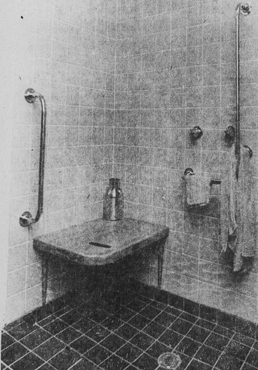
On a fixé sur les murs de la douche et au-dessus du bain des garde-fous en métal qui servent de rampes de sécurité pour les résidents handicapés. Ainsi, l'accès à la chambre de bain leur est plus facile.
