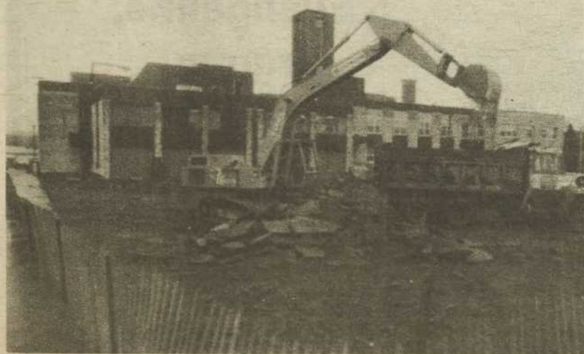
Les travaux d'excavation de la bibliothèque ont débuté, les serrer. Photos Pierre Beaudin
