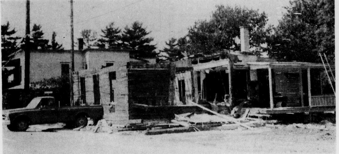
On achève la démolition de 4 propriétés à l'angle des rues Albert et Monfette. Ces démolitions sont nécessaires à la réalisation du programme de rénovation urbaine.
