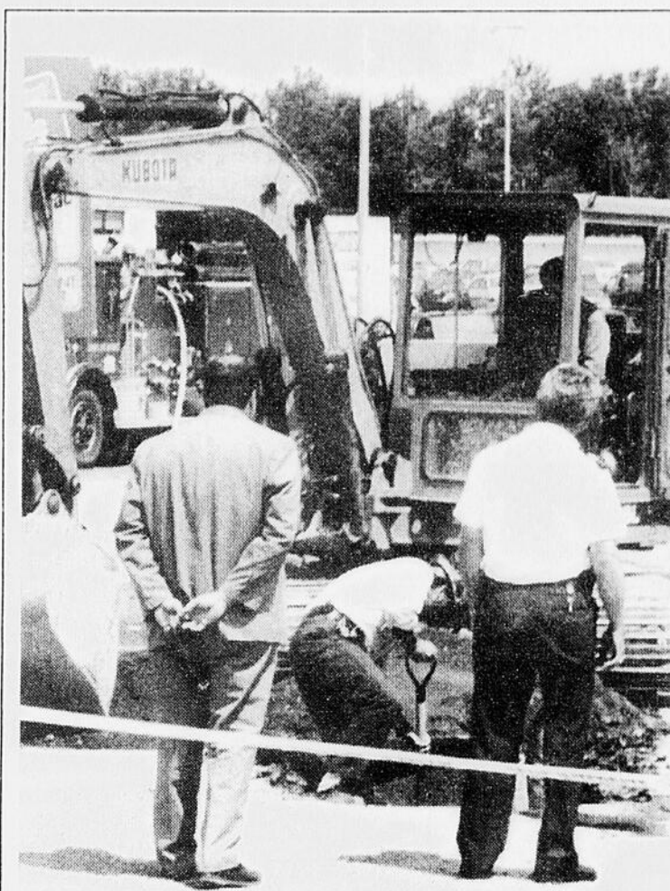
FUITE - Une fuite de gaz naturel, provoquée par des travaux d'excavation, a obligé la Sûreté municipale d'Alma à faire une surveillance étroite aux Galeries Lac-Saint-Jean sur l'heure du midi hier. Le centre commercial n'a toutefois pas été évacué. (Photo Steve Tremblay)
