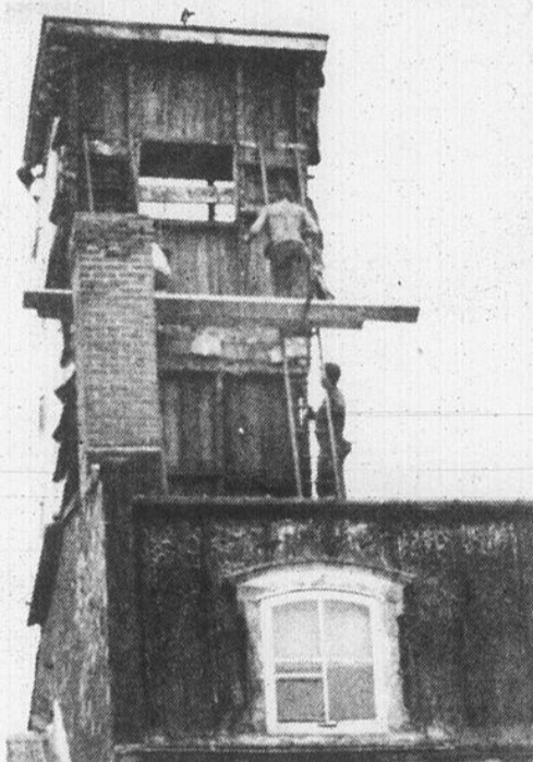
La tour jadis employée par les pompiers pour faire sécher leurs boyaux a été abattue la semaine dernière. Elle était trop pourrie, semble-t-il. (Photo Jacques Paul)
