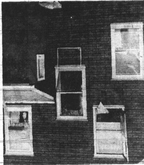
Toutes les fenêtres du côté de la maison ont été arrachées.
