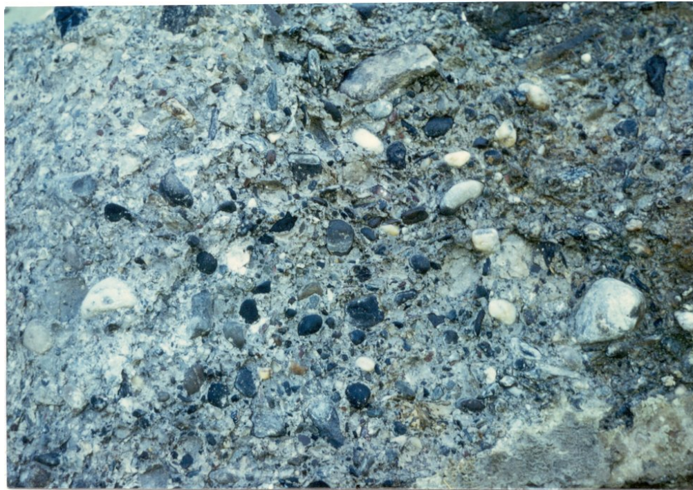
Photo 3.2.2 a) – Désagrégation légère d'une surface de béton
