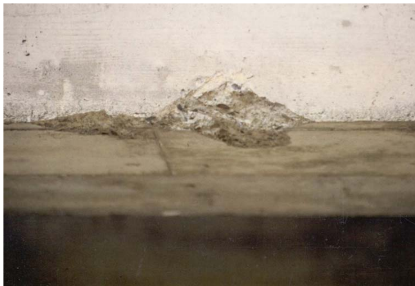
Photo 3.2.6 a) – Éclatement léger d'une poutre
