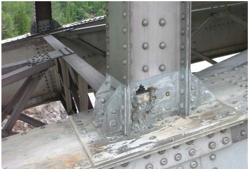
Photo 3.6.1 b) – Corrosion très importante à la base d'un montant d'un pont en arc
