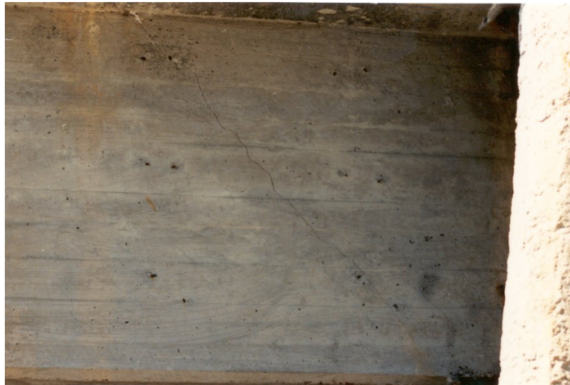
Photo 9.3.3 a) – Extrémité d'une poutre en béton armé
