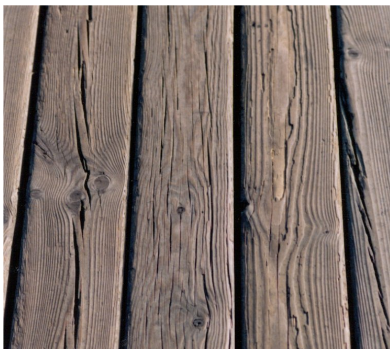
Photo 3.4.1 e) – Vieillissement d'un platelage
