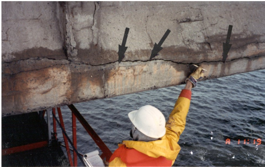
Photo 9.3.3 d) – Extrémité d'une poutre en béton précontraint
