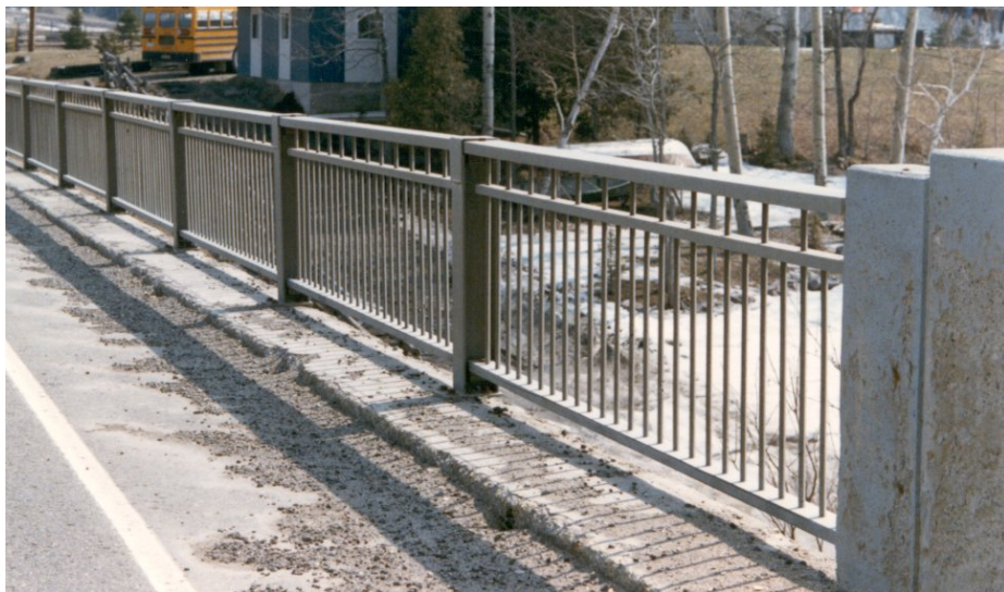
Photo 10.4.3 d) – Chasse-route en béton armé
