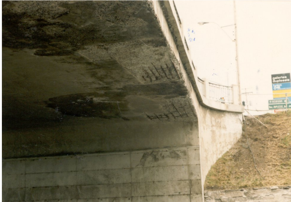
Photo 9.3.3 g) – Dessous à l'extrémité d'une dalle épaisse d'un portique en béton
