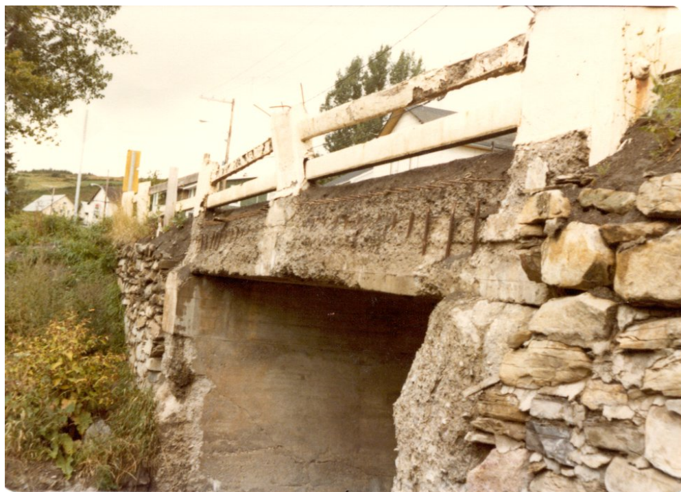
Photo 3.2.2 d) – Désagrégation très importante du côté extérieur d'un pont
