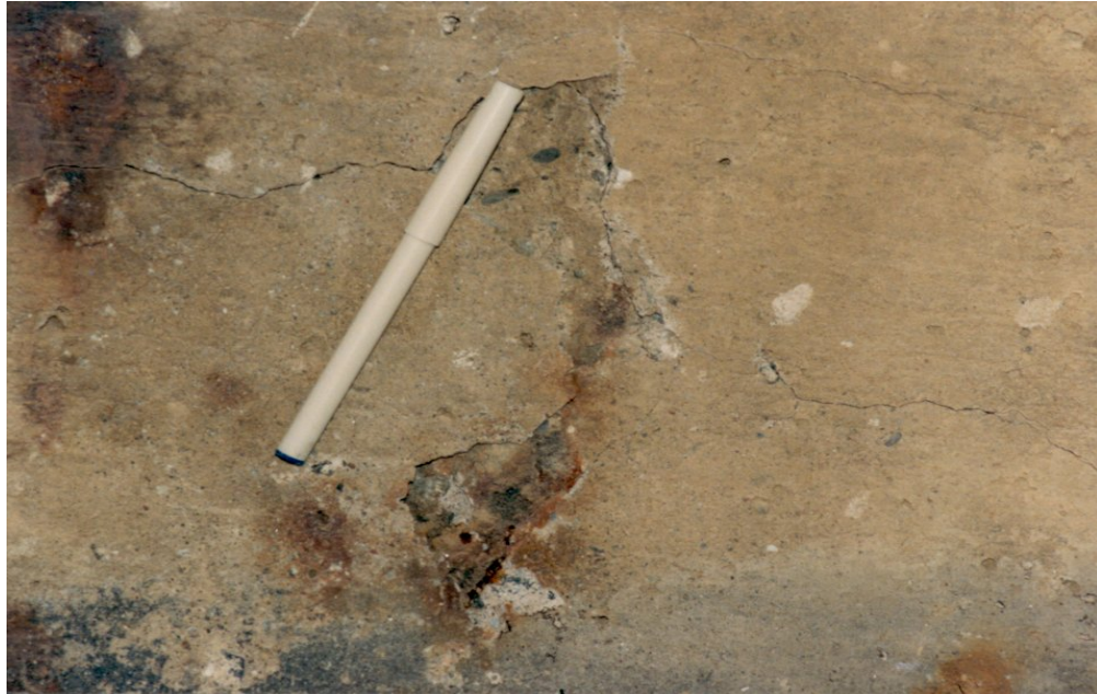
Photo 3.2.5 a) – Délaminage léger d'une surface de béton
