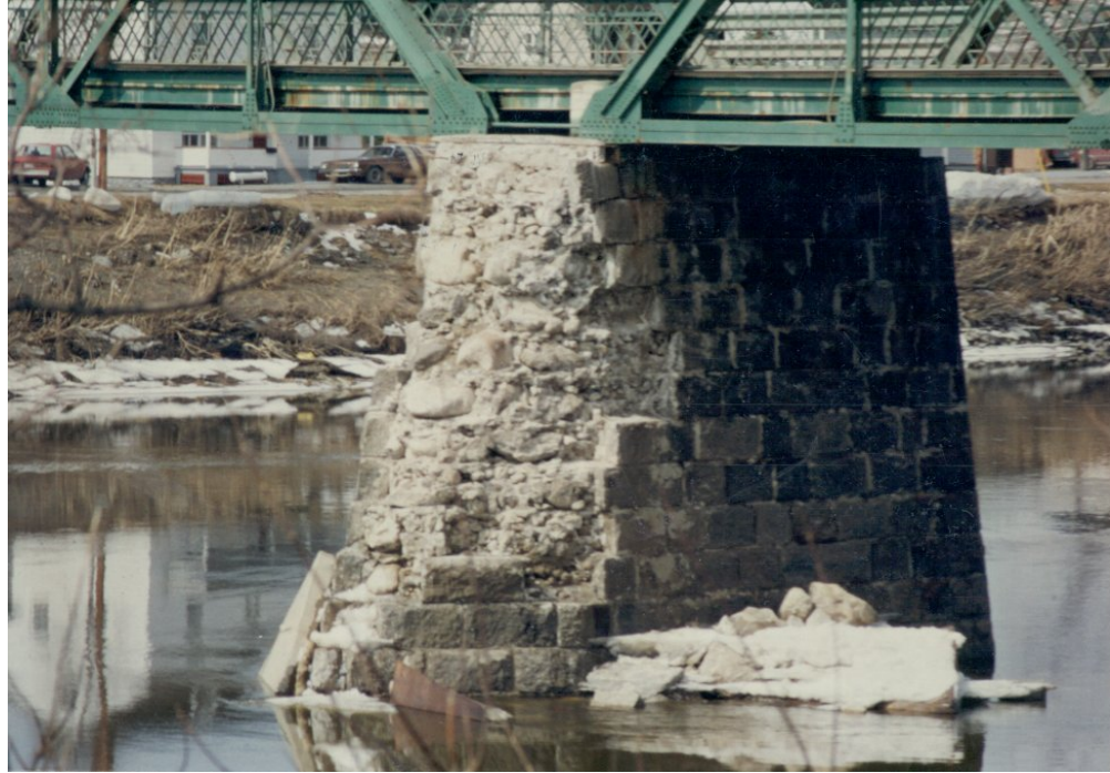
Photo 3.5.2 b) – Décollement des pierres du revêtement d'une pile par l'eau et les glaces
