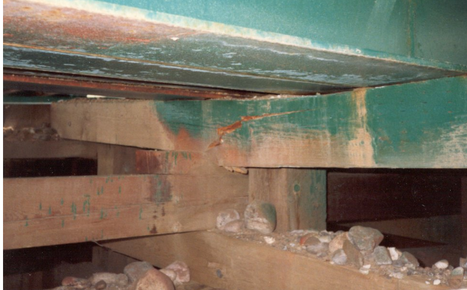
Photo 3.4.6 c) – Rupture d'une pièce
