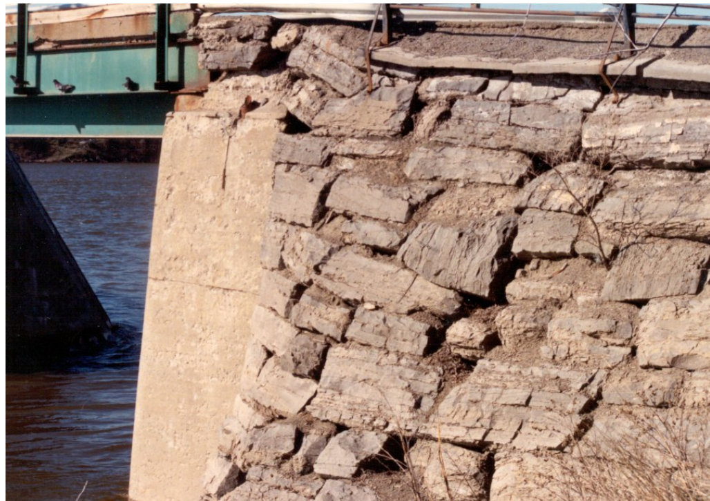
Photo 3.5.2 a) – Désintégration importante dans un mur en retour
