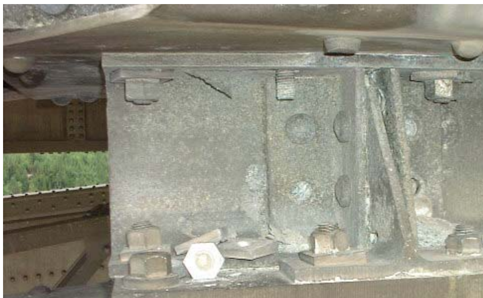
Photo 3.6.3 – Relâchement de l'assemblage d'un montant d'un pont en arc
