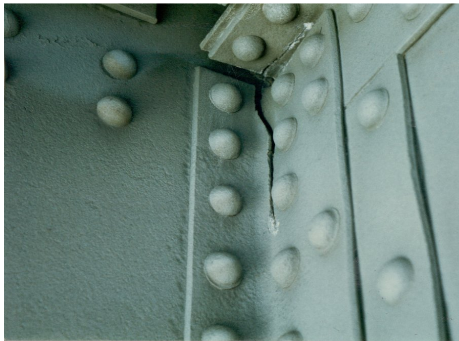
Photo 3.3.3 b) – Fissure dans un assemblage riveté
