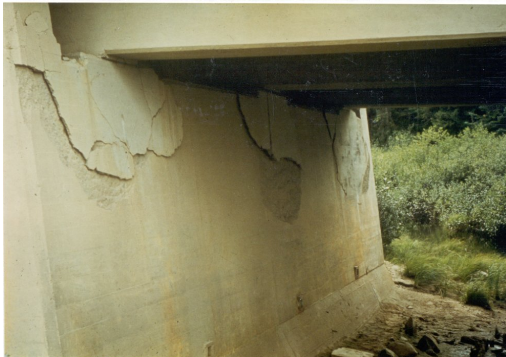
Photo 3.2.6 c) – Éclatement important du mur de front d'une culée
