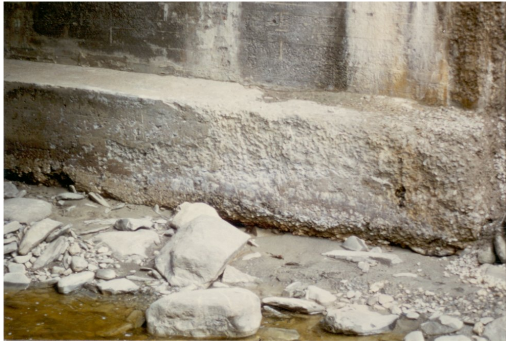
Photo 3.2.3 a) – Érosion légère de la semelle d'une pile
