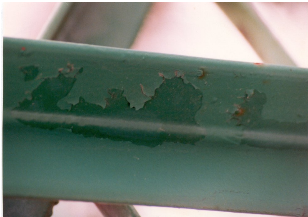
Photo 3.8.2 b) – Pelage et délaminage
