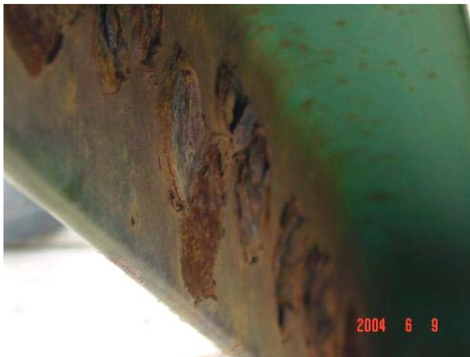
Photo 3.3.1 b) – Corrosion moyenne d'une diagonale
