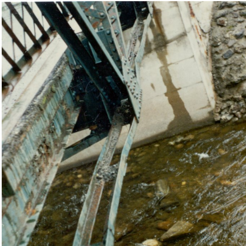
Photo 3.3.2 a) – Déformation de la corde inférieure d'une poutre triangulée
