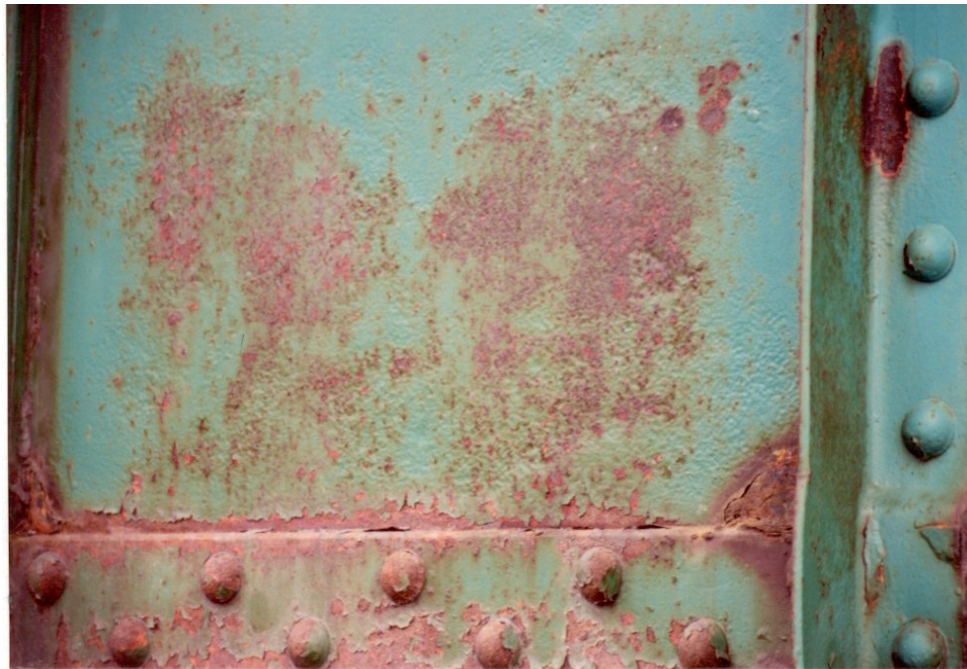
Photo 3.3.1 a) – Légère corrosion de l'âme d'une poutre
