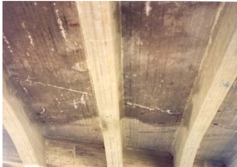
Photo 10.3.3 a) – Dessous au centre d'une dalle sur poutres en béton armé
