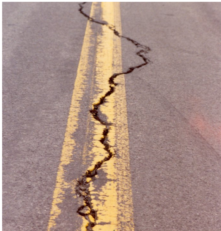
Photo 3.7.1 b) – Fissure de centre
