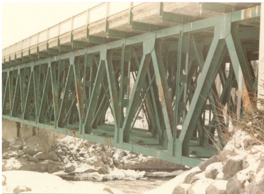
Photo 12.3.3 f) – Revêtement des diagonales d'une poutre triangulée de rive – éléments principaux
