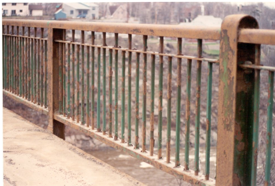
Photo 12.3.3 h) – Poteaux, lisses et barreaux d'un dispositif de retenue – éléments secondaires
