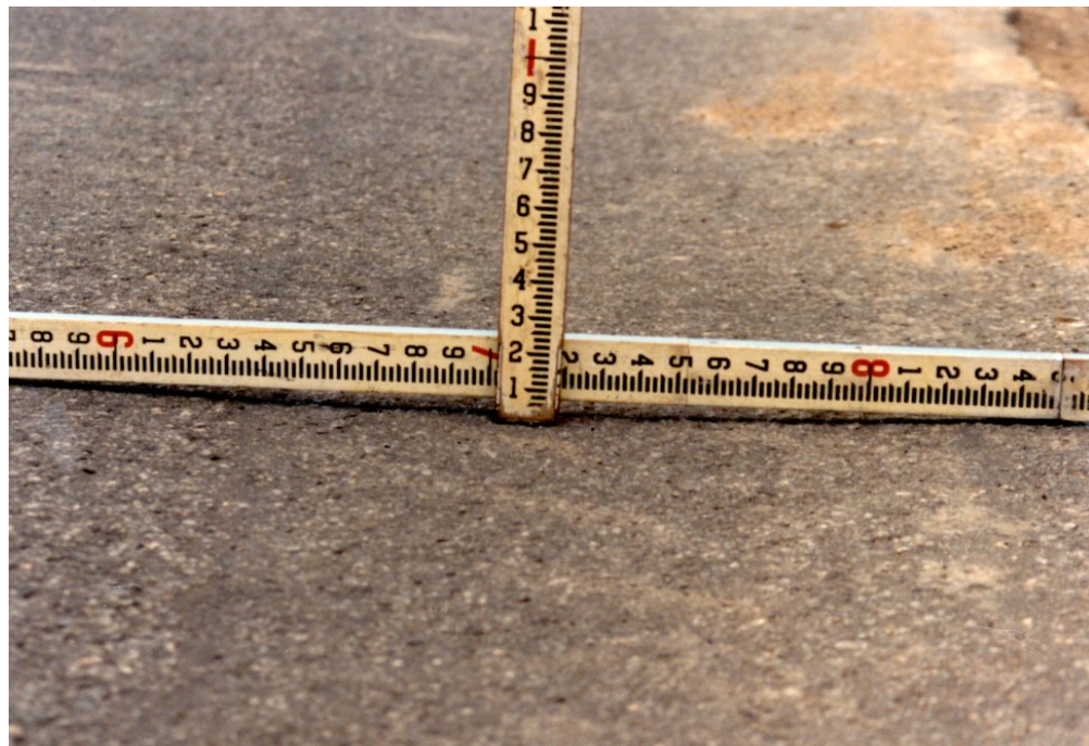
Photo 3.7.5 a) – Orniérage léger
