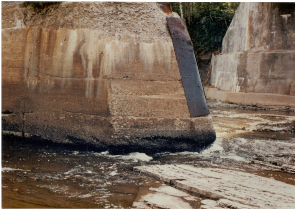
Photo 3.2.3 d) – Érosion très importante de la semelle d'une pile
