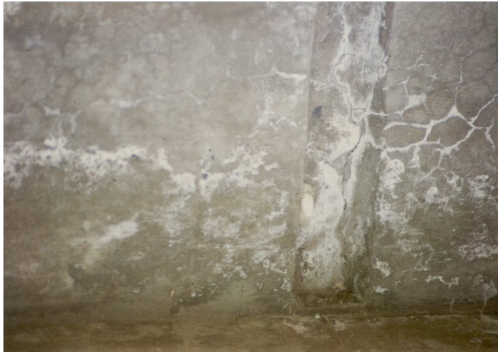
Photo 3.2.9 a) – Efflorescence sous une dalle
