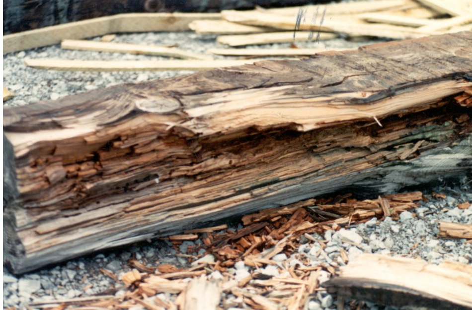
Photo 3.4.2 d) – Pourriture très importante d'une pièce
