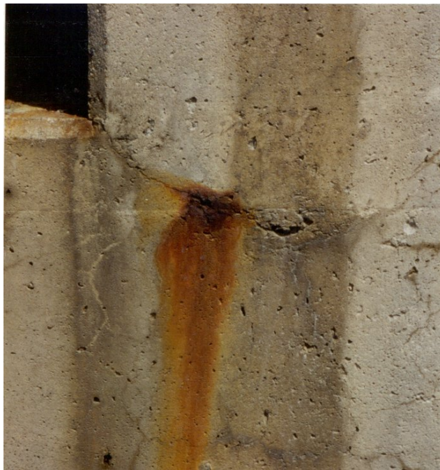
Photo 3.2.4 a) – Légère tache de rouille à la surface du béton
