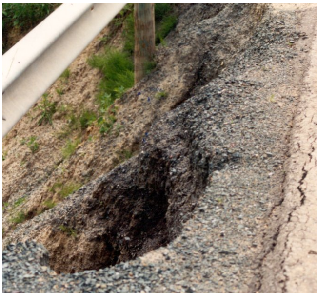
Photo 10.5.3 d) – Drainage et système de drainage à l'approche
