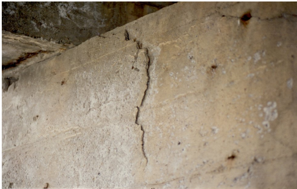
Photo 3.2.5 b) – Délaminage moyen d'une surface de béton
