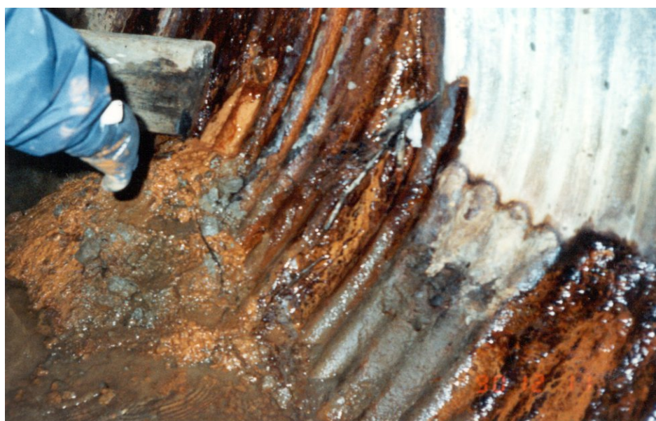
Photo 13.3.3 j) – Coin inférieur d'un ponceau en acier
