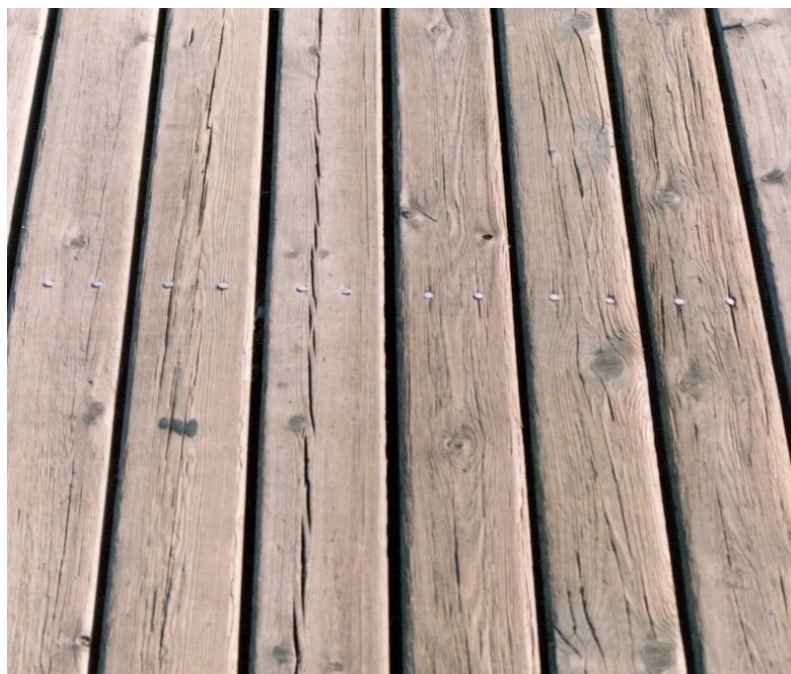
Photo 3.4.1 d) – Vieillissement d'un platelage
