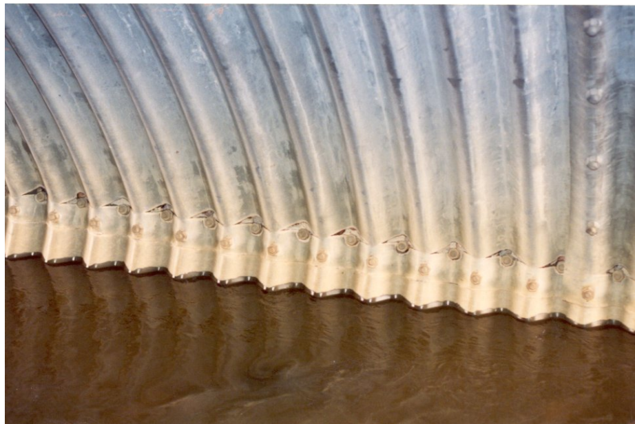
Photo 13.3.3 f) – Coin inférieur d'un ponceau en acier.
