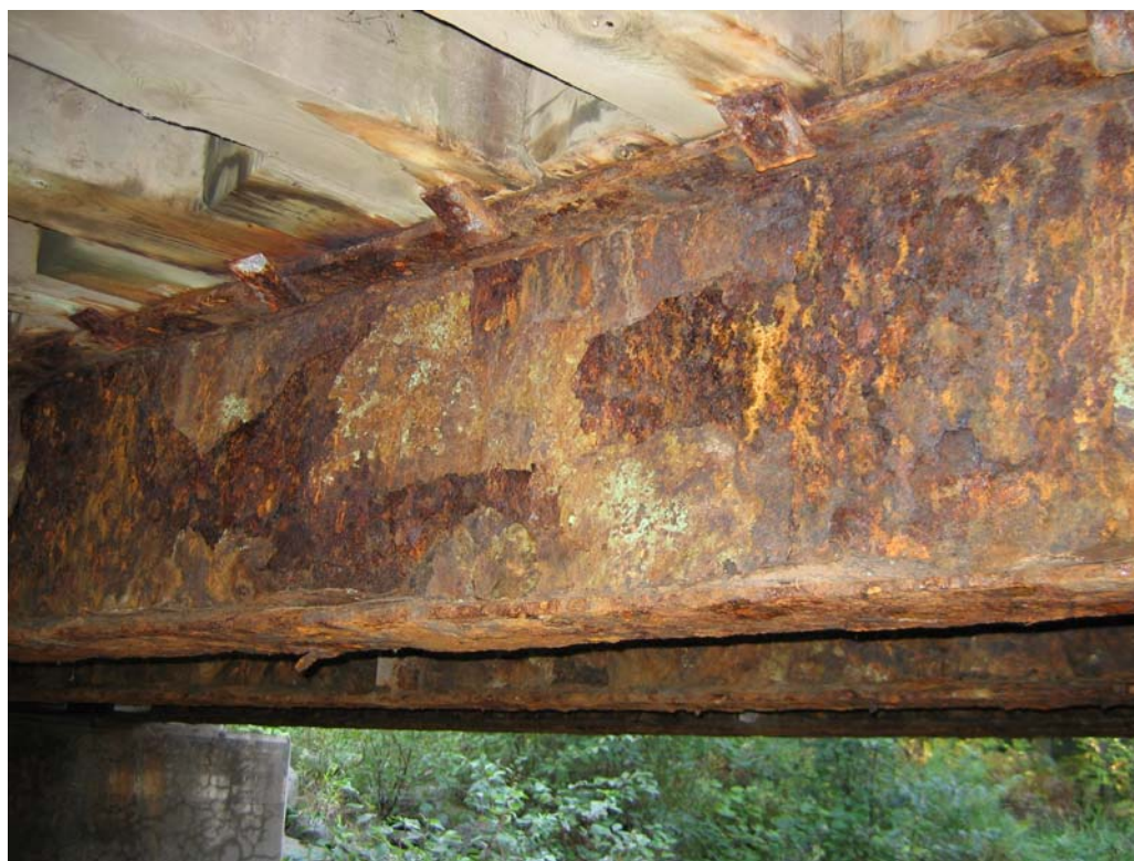
Photo 3.3.1 c) – Corrosion importante d'une poutre
