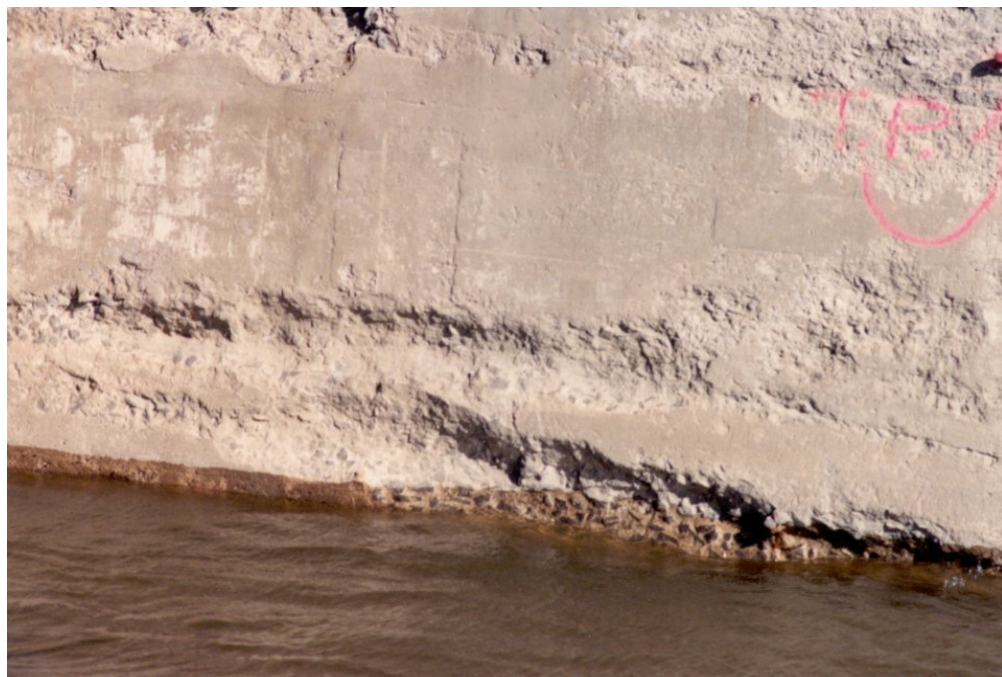
Photo 3.2.3 b) – Érosion moyenne du fût d'une pile
