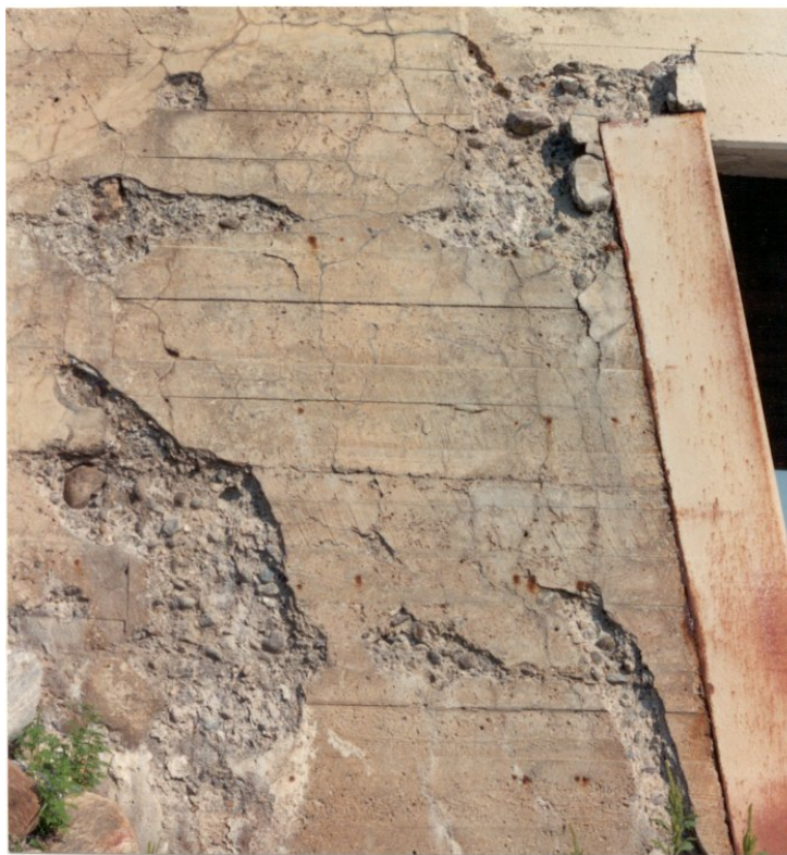
Photo 3.2.1 d) – Écaillage très important d'un mur en retour d'une culée
