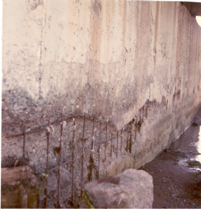
Photo 3.2.3 c) – Érosion importante du mur de front d'une culée
