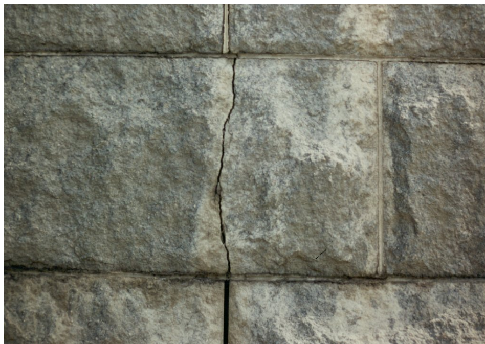
Photo 3.5.1 a) – Fissure moyenne dans la pierre et les joints d'un ouvrage
