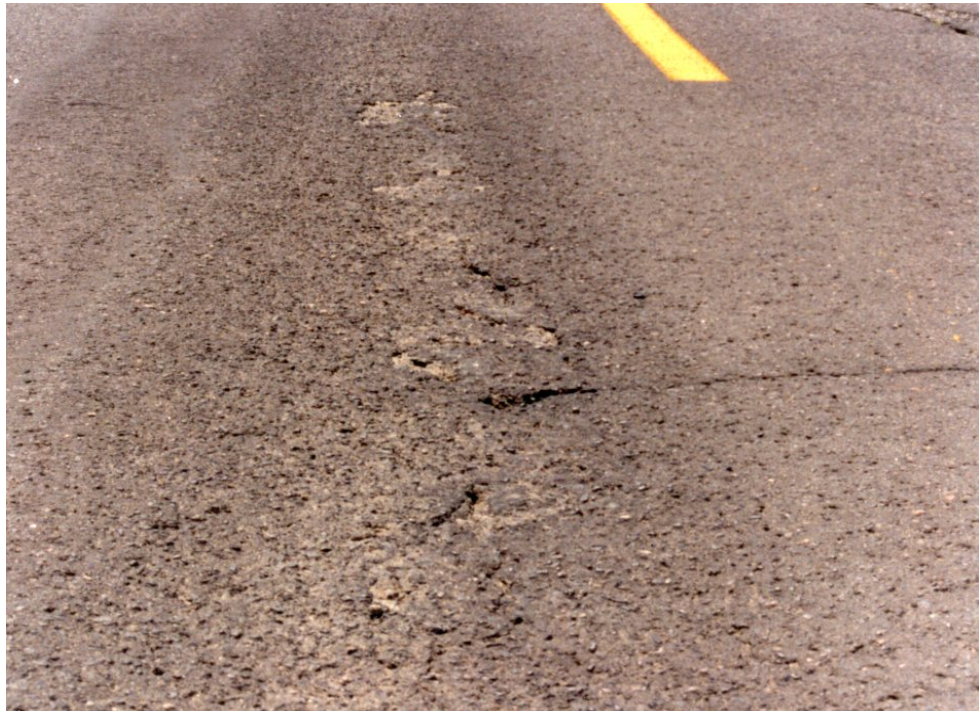
Photo 3.7.2 c) – Désenrobage et arrachement important
