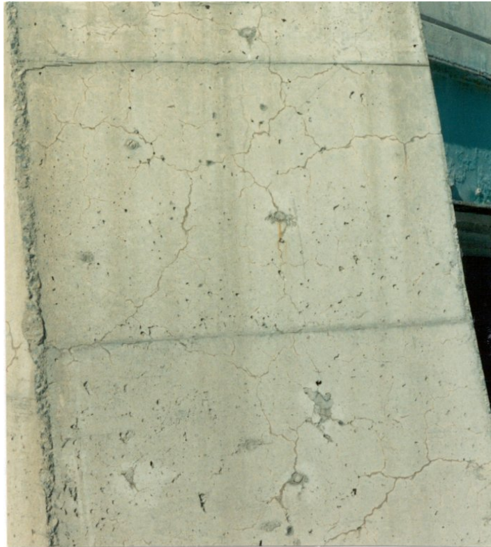
Photo 3.2.7 c) – Fissures en forme de réseau
