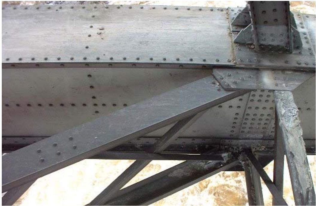
Photo 3.6.1 a) – Corrosion légère d'un arc
