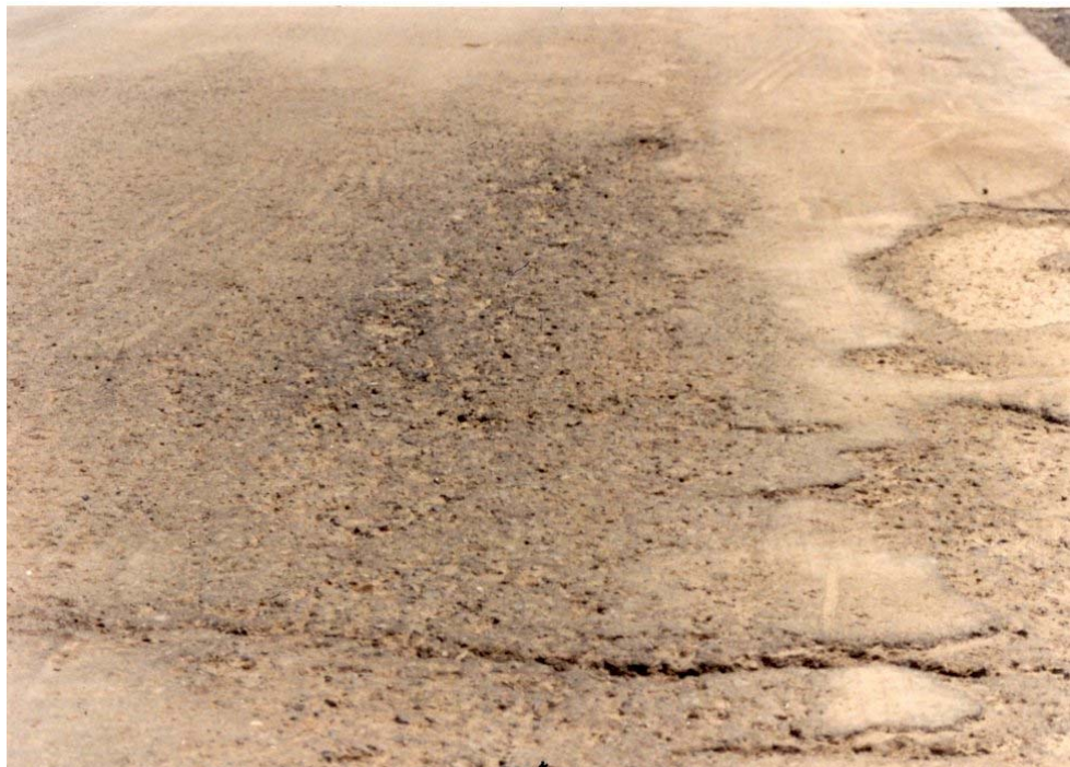
Photo 3.7.2 d) – Désenrobage et arrachement très important
