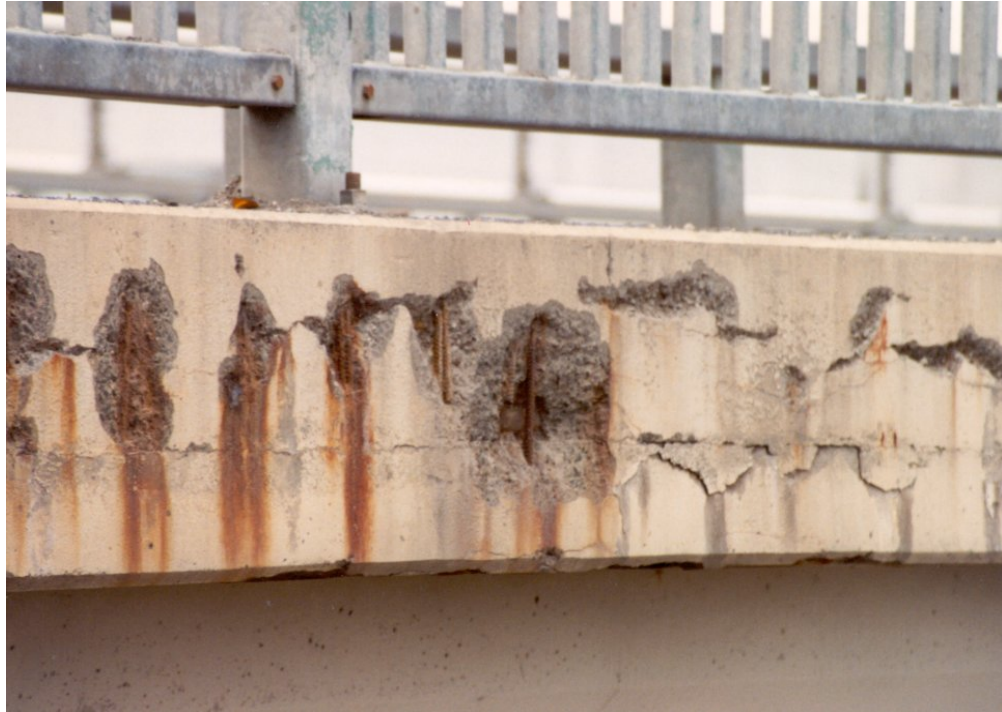
Photo 3.2.6 b) – Éclatement moyen du côté extérieur d'un pont
