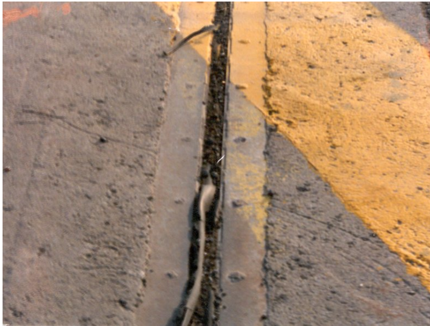
Photo 8.3.3 f) – Garniture d'un joint à garniture comprimée
