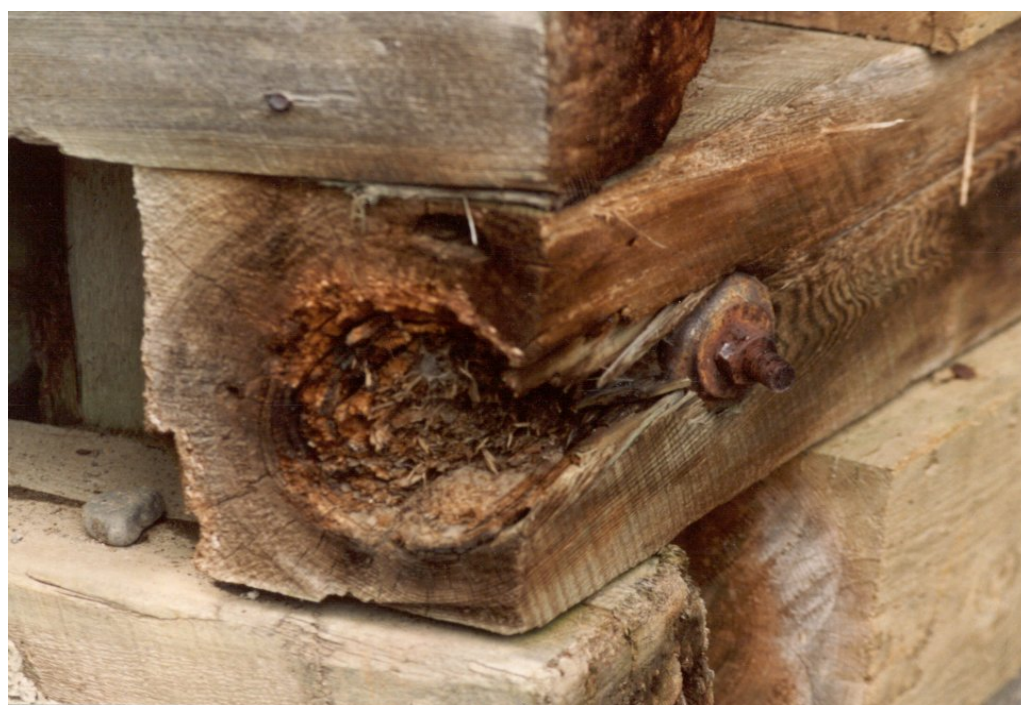
Photo 3.4.2 c) – Pourriture importante de l'extrémité d'une pièce
