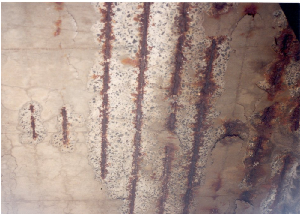
Photo 3.2.4 c) – Corrosion importante de l'armature
