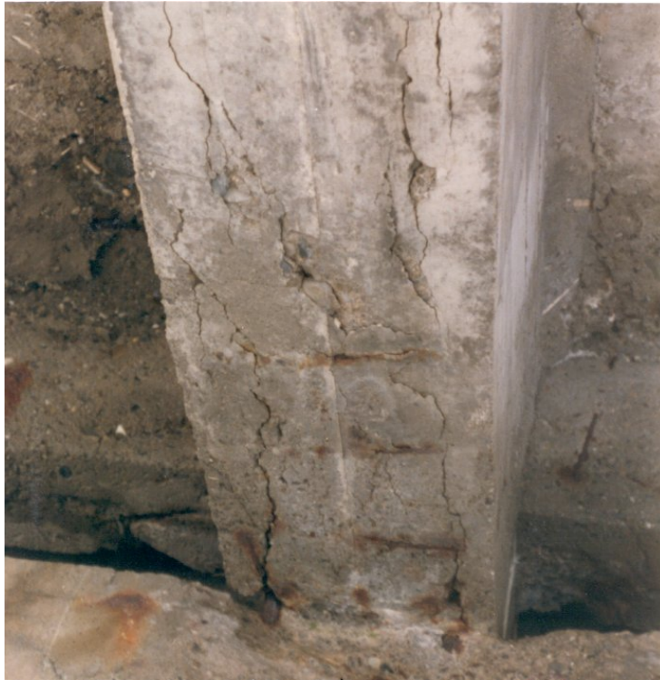
Photo 3.2.5 c) – Délaminage important du dessous d'une poutre
