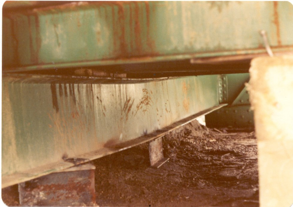
Photo 3.3.2 b) – Fléchissement d'une entretoise
