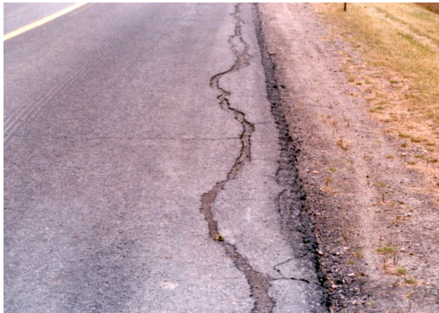
Photo 3.7.1 d) – Fissure latérale
