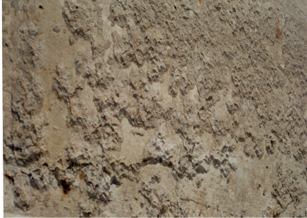
Photo 3.2.1 a) – Écaillage léger du mur de front d'une culée
