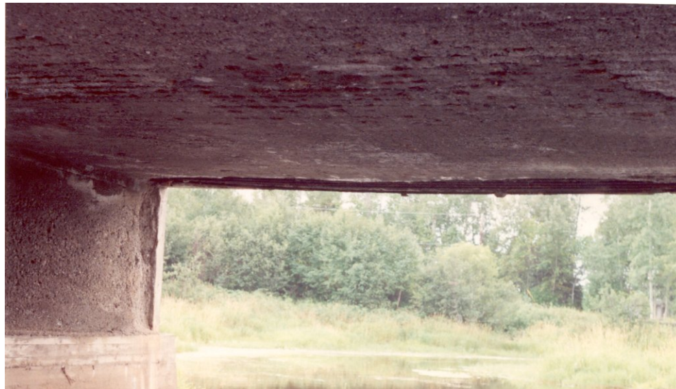
Photo 9.3.3 f) – Dessous à l'extrémité d'une dalle épaisse en béton armé
