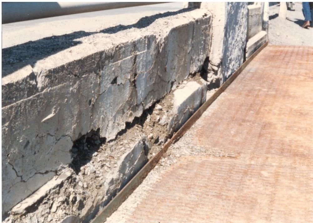
Photo 3.2.2 c) – Désagrégation importante du parapet d'un pont
