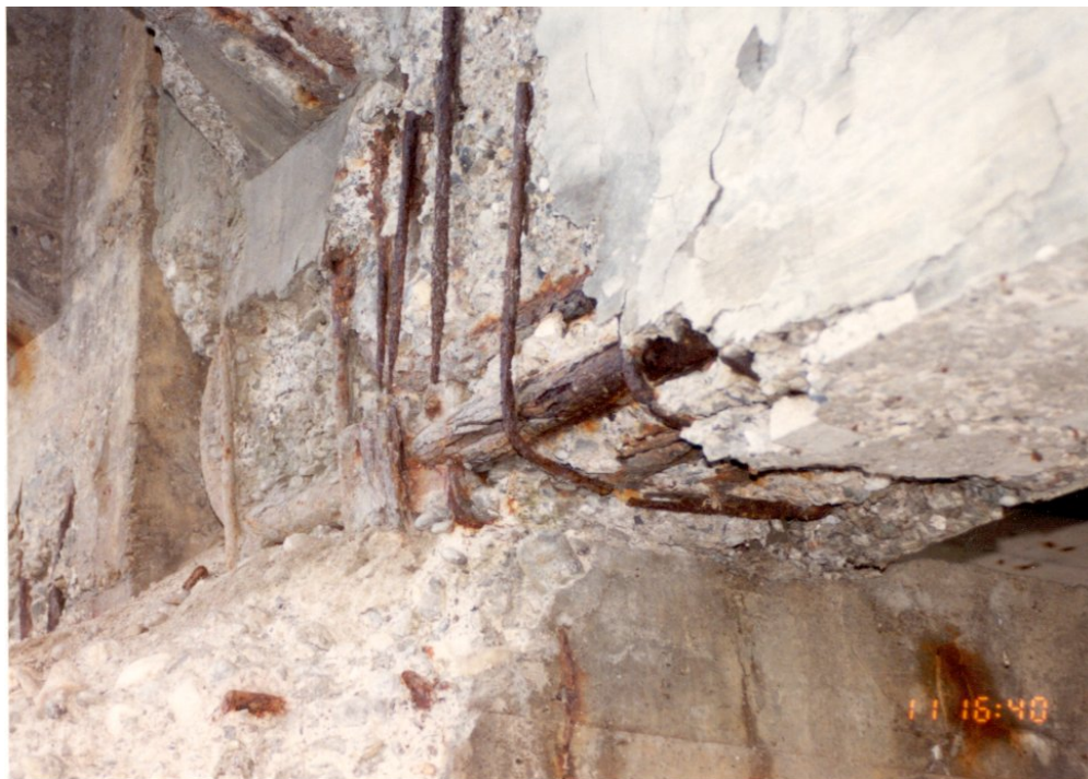
Photo 3.2.4 d) – Barres d'armature sectionnées à la suite d'une corrosion très importante
