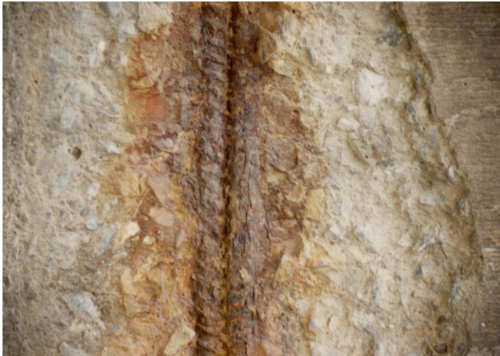
Photo 3.2.4 b) – Corrosion moyenne de l'armature
