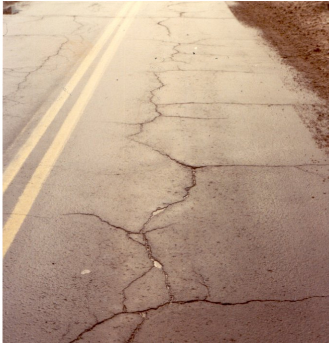
Photo 3.7.1 e) – Fissures polygonales moyennes
