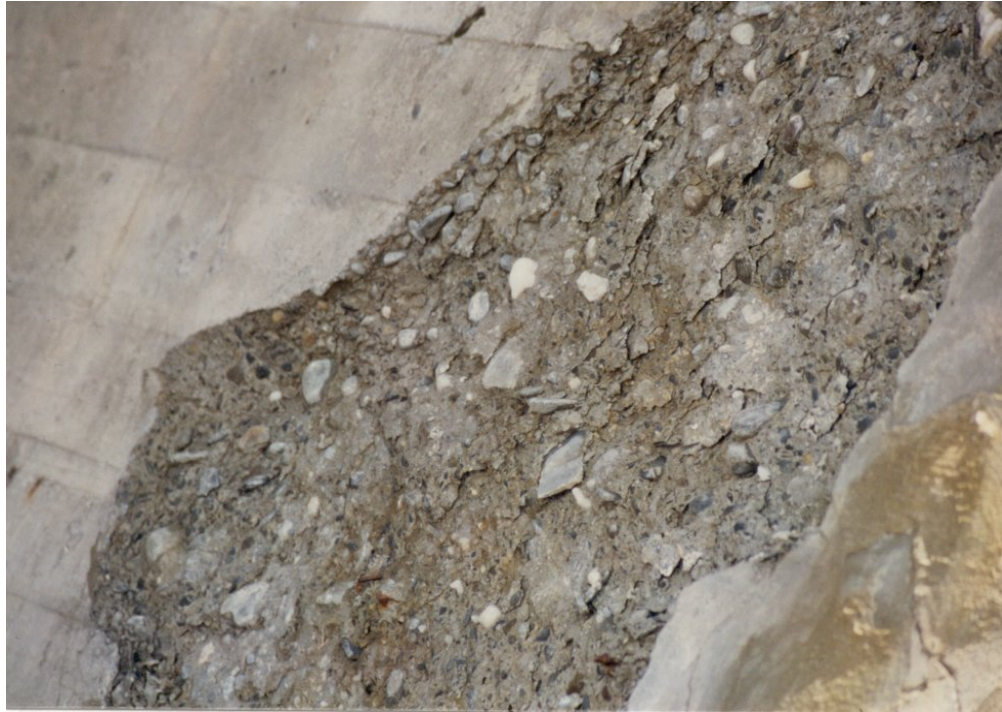
Photo 3.2.1 c) – Écaillage important du mur de front d'une culée
