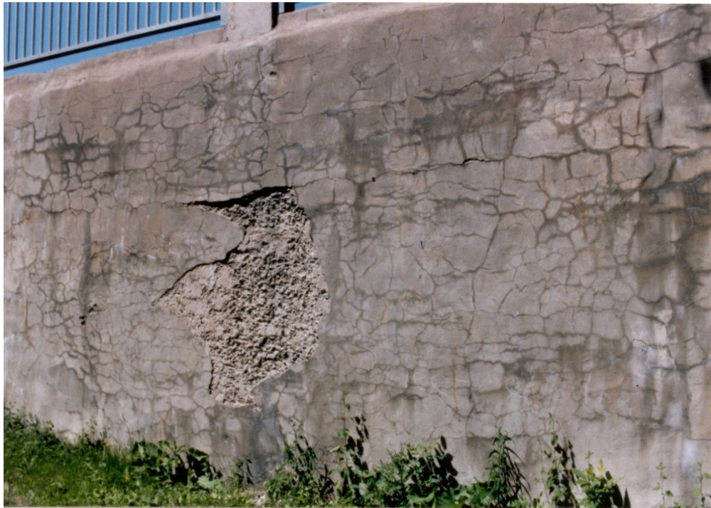
Photo 3.2.2 b) – Désagrégation moyenne d'un mur de soutènement
