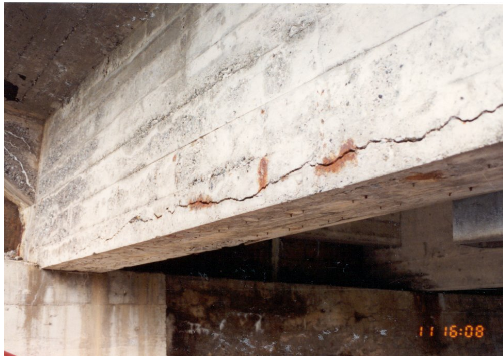
Photo 3.2.5 d) – Délaminage très important du dessous d'une poutre
