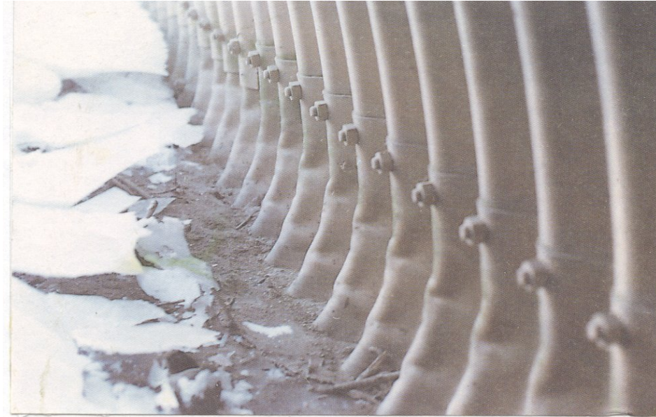
Photo 13.3.3 e) – Coin inférieur d'un ponceau en acier
