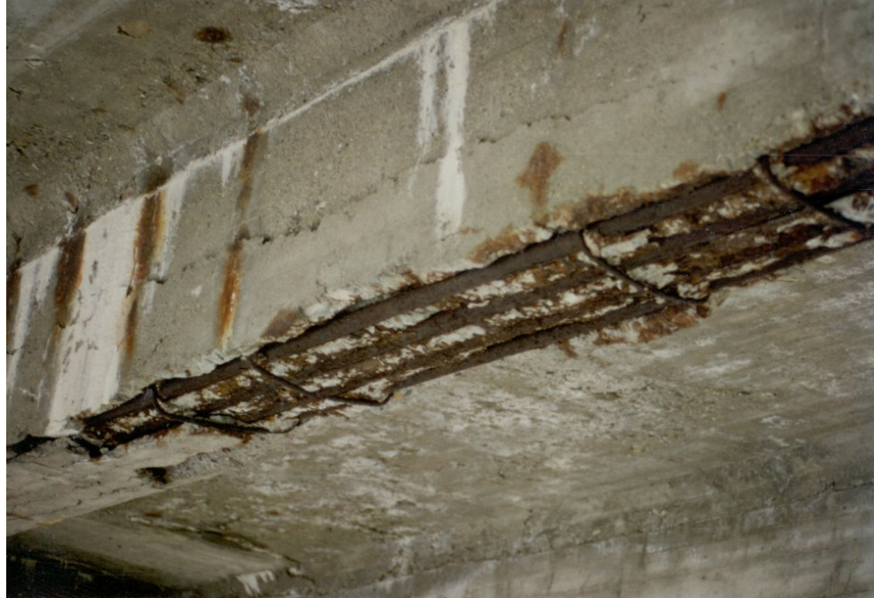
Photo 3.2.6 d) – Éclatement et délaminage très importants du dessous d'une poutre
