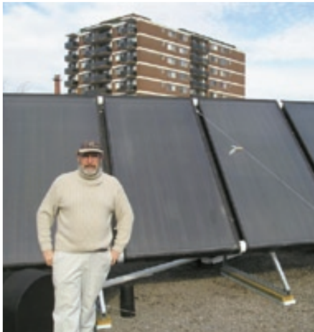
Installation de huit panneaux solaires usagés, une des mesures implantées par la Coop Les Tourelles (3575-3597 Jeanne-Mance). La consommation annuelle d'électricité est conséquemment passée de 75 000 à 66 000 mètres cubes.
