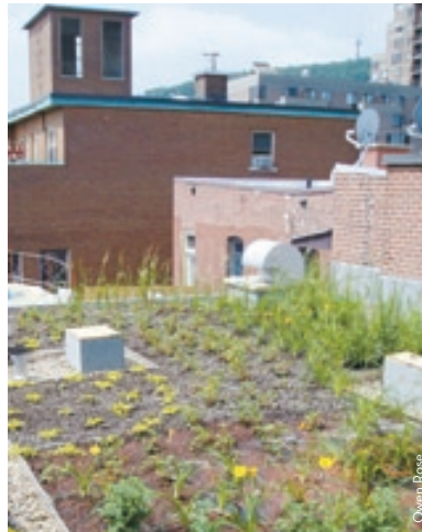
Projet pilote toit vert (efficacité énergétique) du Centre d'écologie urbaine de Montréal.
