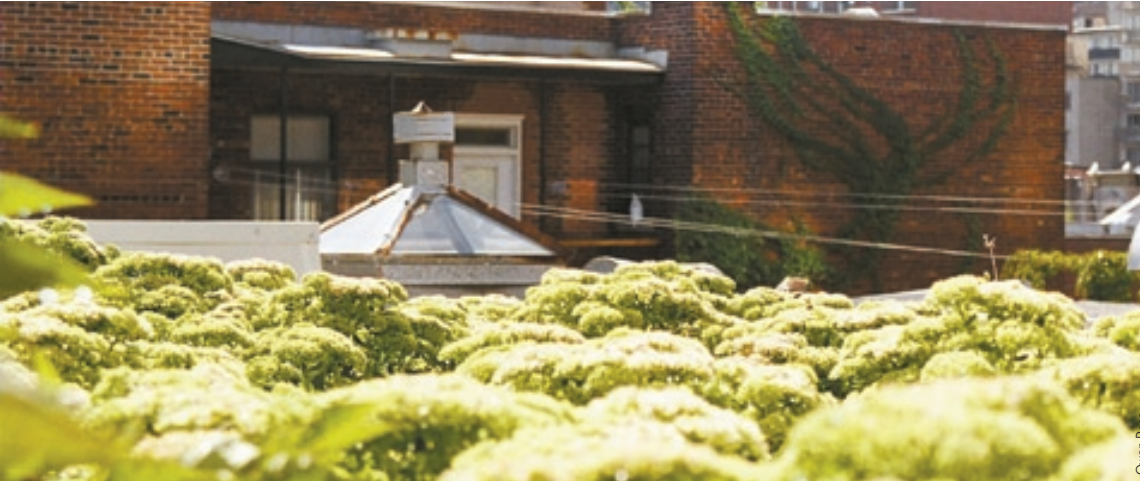
Projet pilote toit vert, du Centre d'écologie urbaine de Montréal
