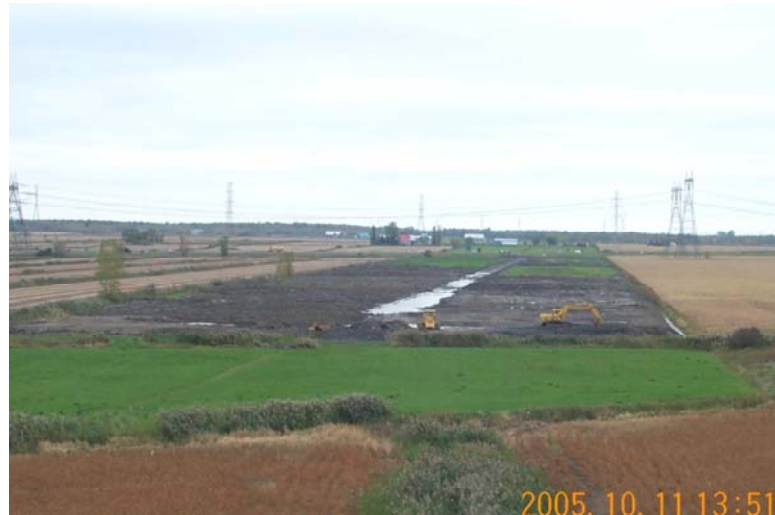
Figure 14 : Photo de remblayage effectué sans autorisation à Boucherville
