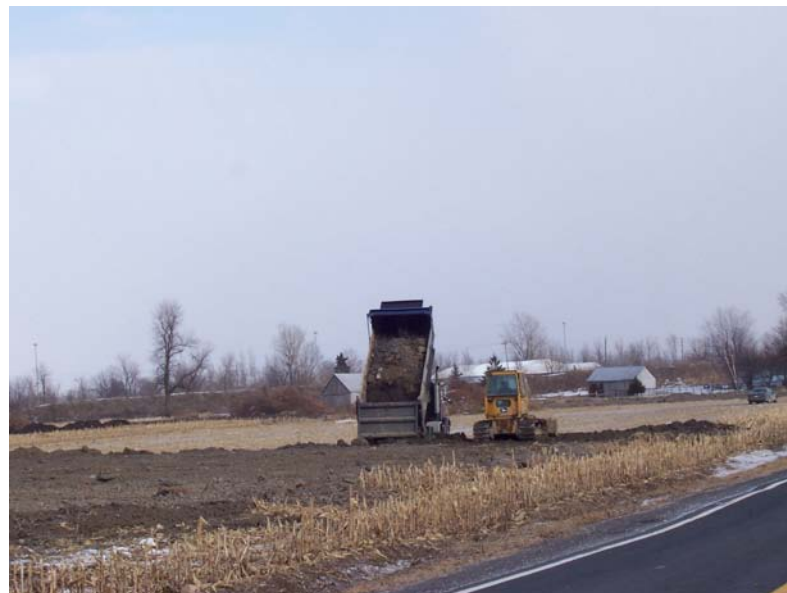
Figure 15 : Photo de remblayage effectué sans autorisation à Brossard
