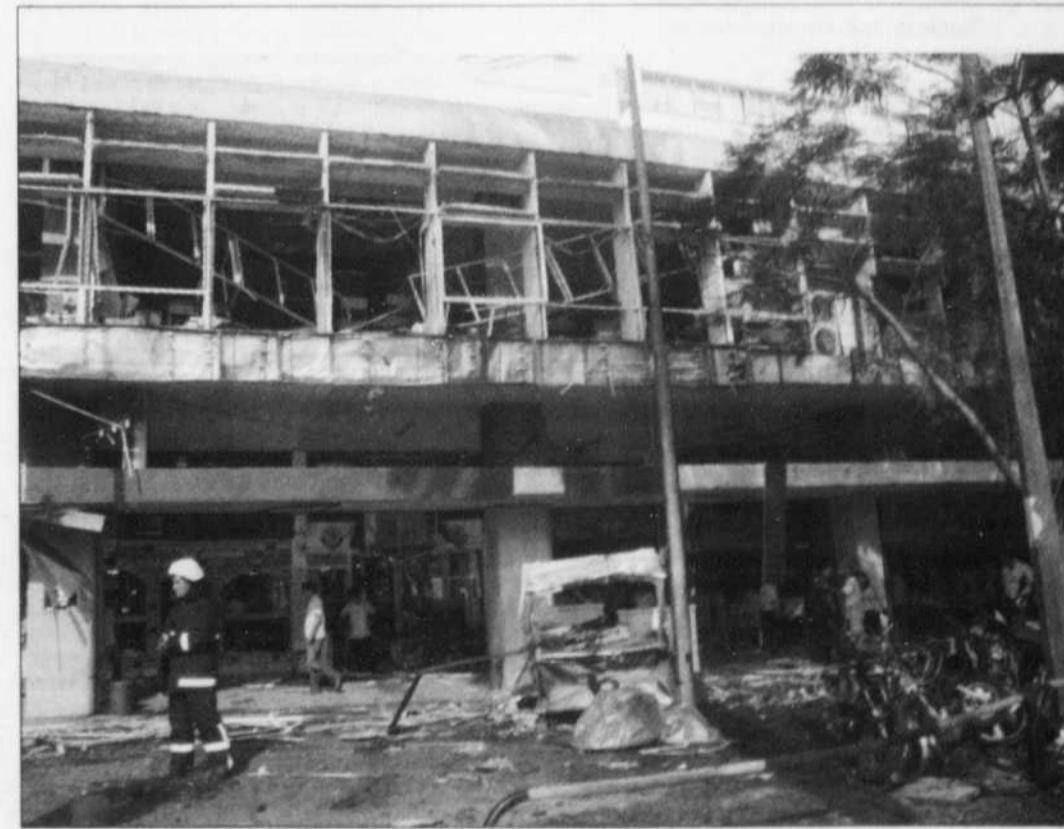
Un pompier examinait les dommages causés par un des explosions lundi à Antalya.
