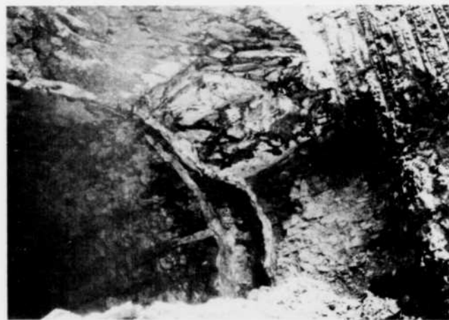
Figure 4 — Hors-profil créé par un éboulis mineur au coin nord-est de la station Lionel Groulx. Calcaires de Tétreauxville fracturés recoupés au centre de la photo par deux dykes altérés.
