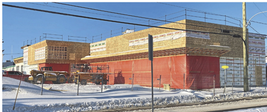
L'année 2024 a permis à la nouvelle Ville de Plessisville d'enregistrer des investissements pour une valeur déclarée des travaux de 50,3 millions $. Sur la photo, la Place Mia en construction. (Photo www.lanouvelle.net)
