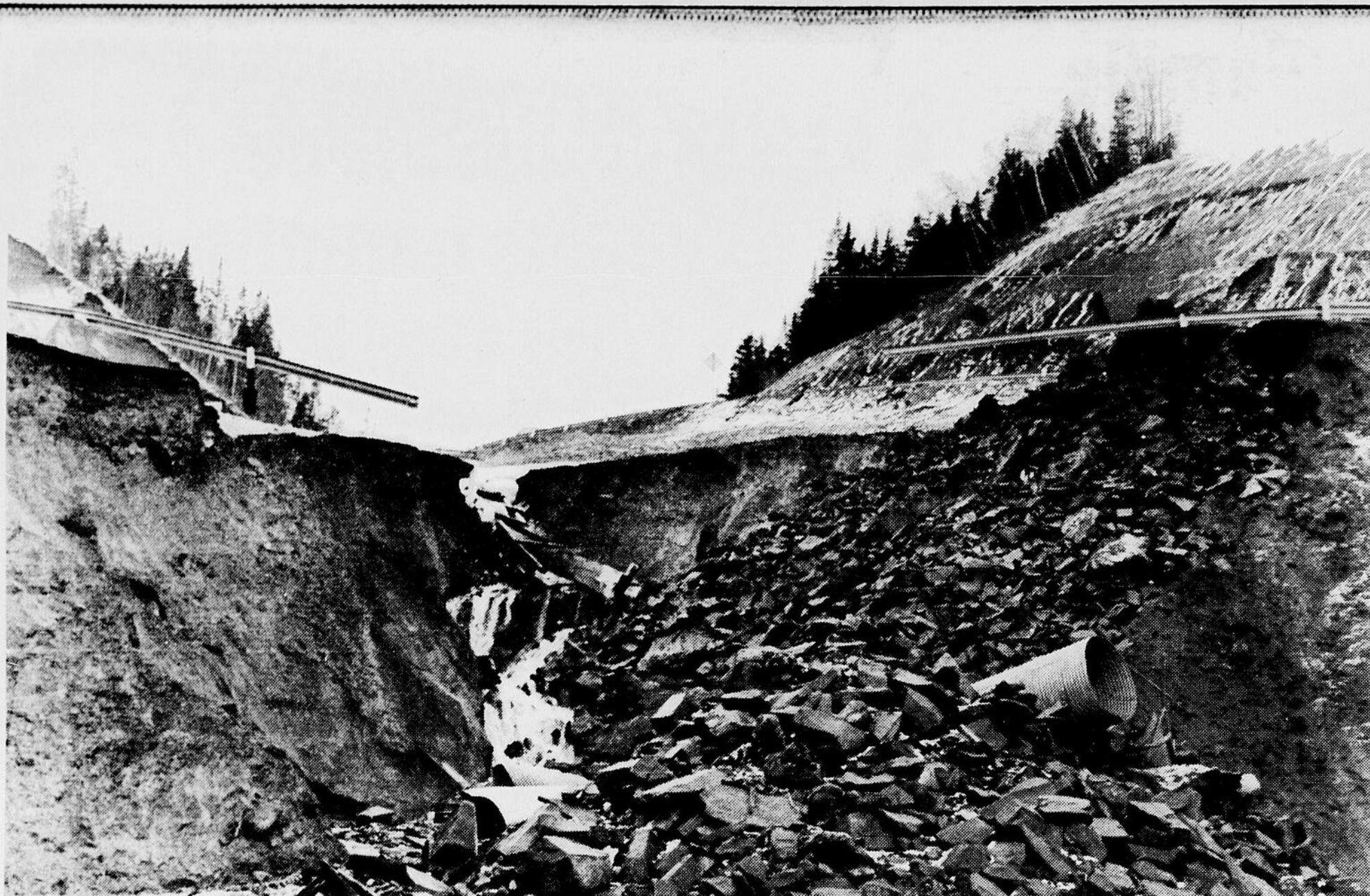
On a commencé à basculer des tonnes de roc dans le gouffre provoqué par les débordements du ruisseau qui descend de la coulée de St-Léandre, débordements qui ont eu pour effet de couper complètement la route de la rive ouest de la rivière. Même s'il y avait eu de la neige en quantité suffisante au centre de ski, il eut été difficile pour la plupart des véhicules de s'y rendre. [Photos Gilles Gagné]
