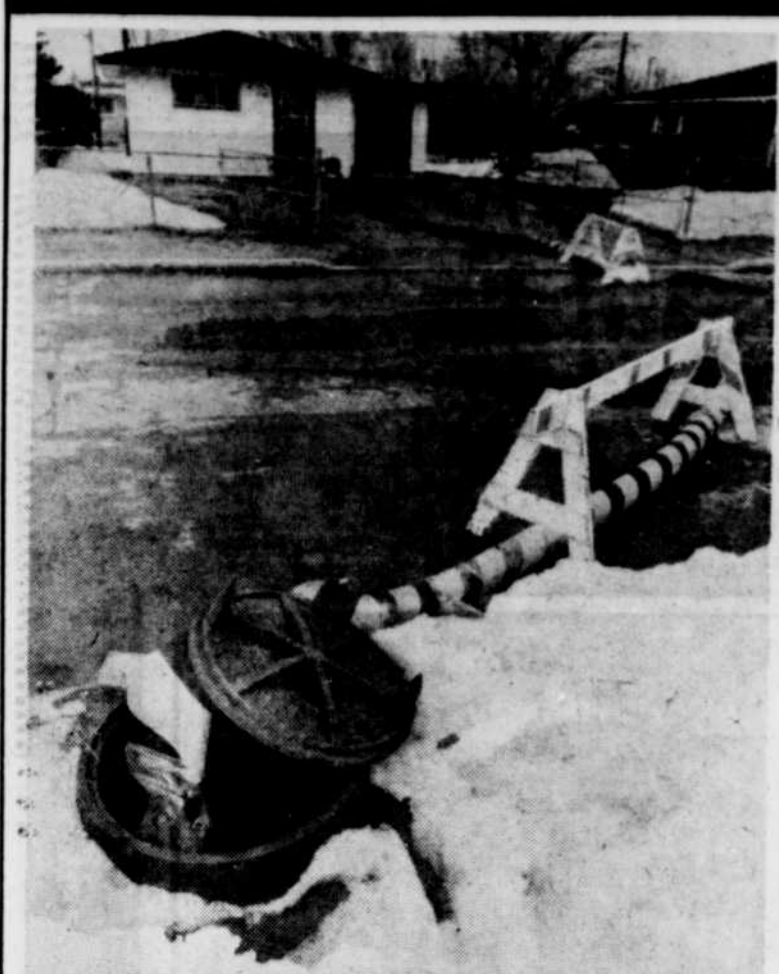
Un trop plein
