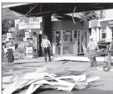
Le vent a complètement arraché le toit d'une station-service du boulevard Laurier, à Sainte-Foy. — PHOTO LE SOLEIL, STEVE DESCHÊNES
