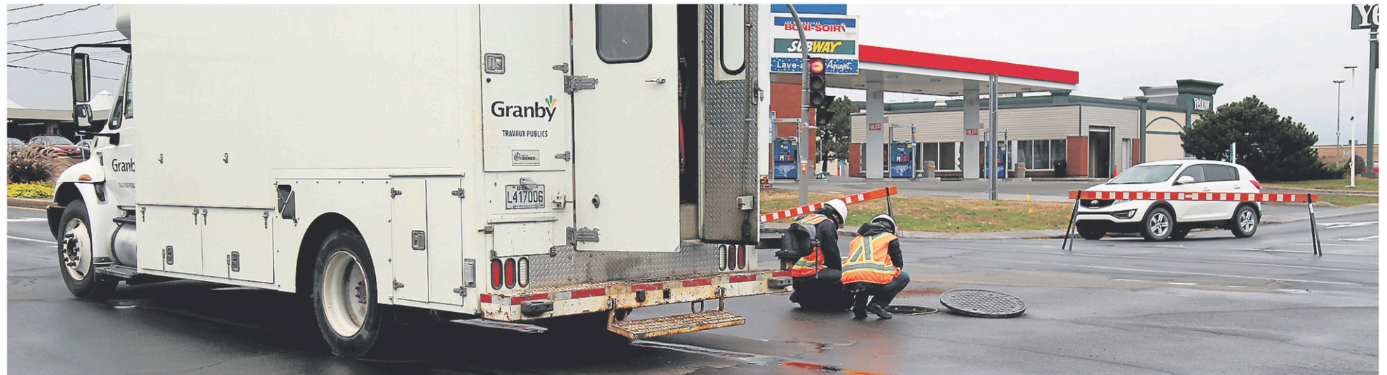
Un bris d'aqueduc a nécessité la fermeture de l'intersection des rues Principale et Simonds. — PHOTO JULIE CATUDAL
