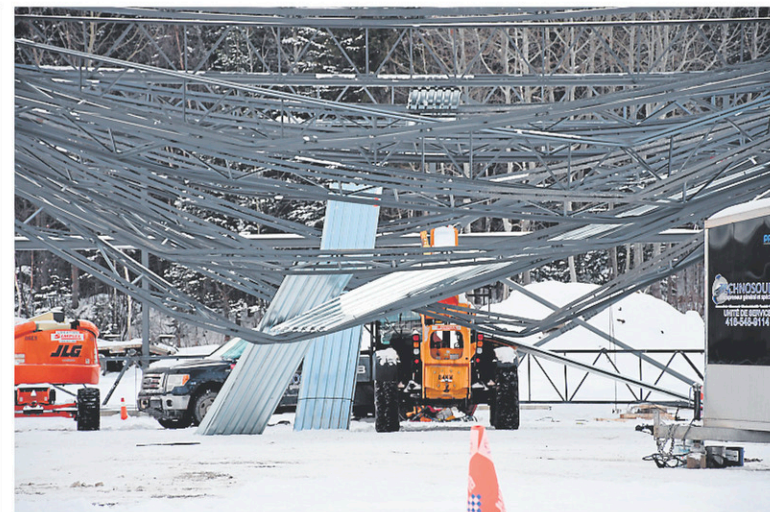
Personne n'a été blessé lors de l'effondrement partiel de la structure. — PHOTO LE QUOTIDIEN, ROCKET LAVOIE
