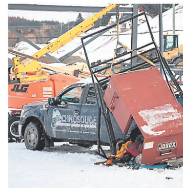
Selon les propos de certains employés, l'effondrement de la structure serait dû à une collision entre un camionnette et un poteau de soutien. — PHOTO LE QUOTIDIEN, ROCKET LAVOIE
