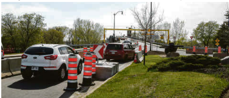
Les élus sorelois sont exaspérés par la lenteur du MTQ dans plusieurs dossiers, dont celui de la réfection du pont Turcotte. Photo Pascal Cournoyer | Les 2 Rives ©
