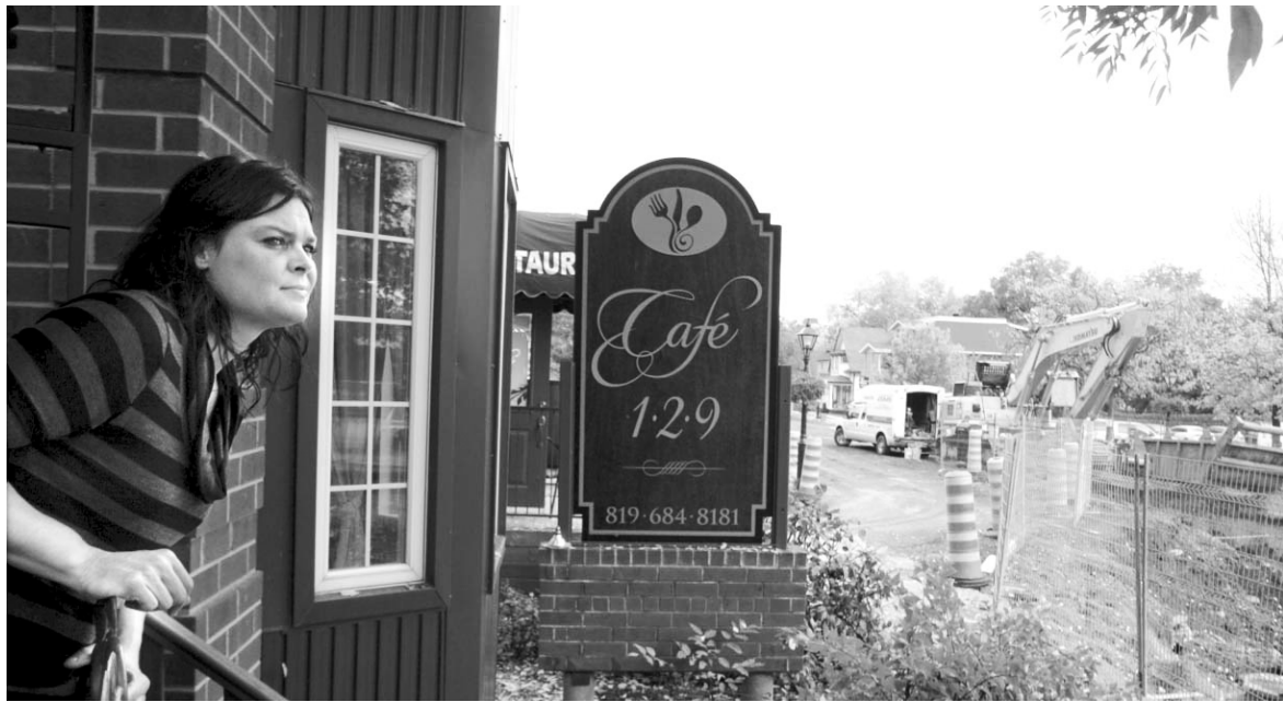
Chantal Labrie, du Café 1.2.9, n'accueille que le quart de sa clientèle habituelle depuis le début des travaux.
