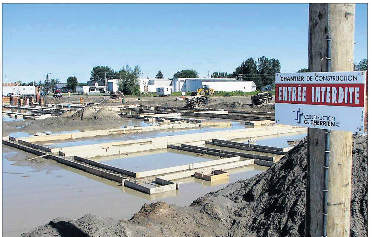
En août 2011, après le passage de la tempête générée par l'ouragan Irène, tout le chantier est inondé.
