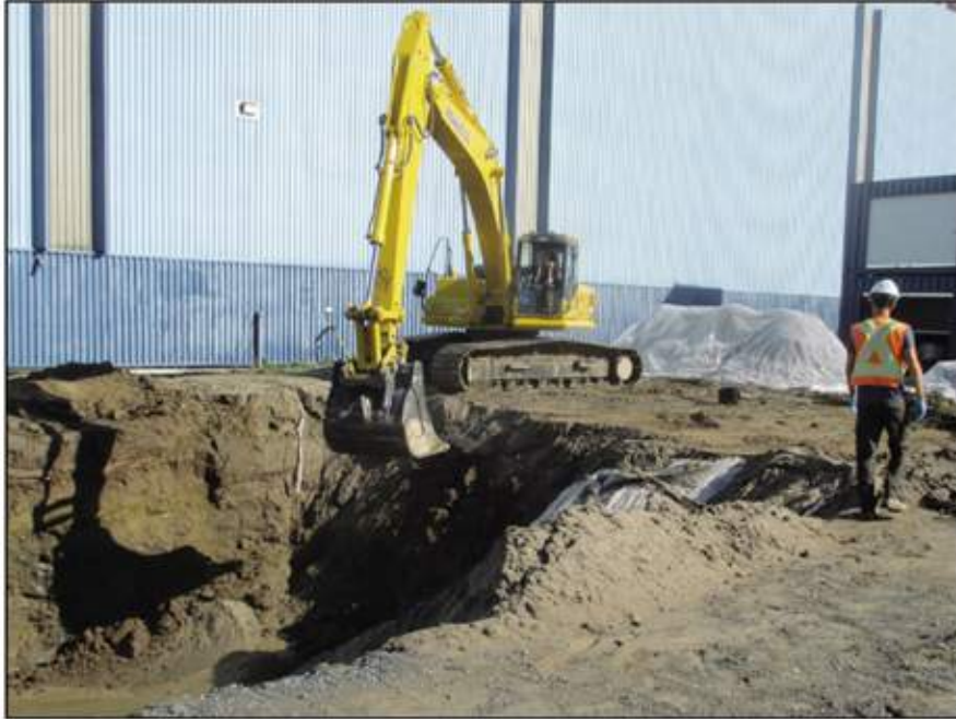
Excavation des sols contaminés et transport vers un site de traitement autorisé
