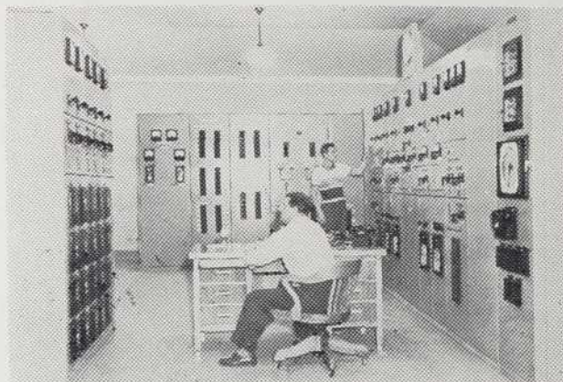
• SALLE DE COMMANDE OÙ EST INSTALLÉ LE TABLEAU
