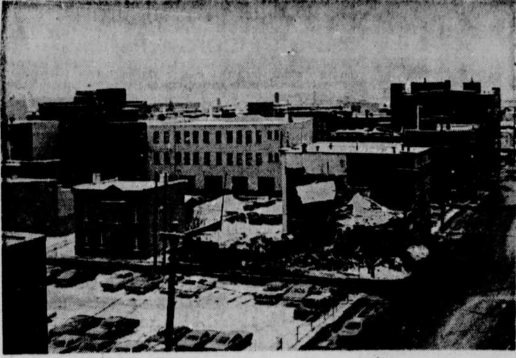
Pour faire place à l'autoroute Dufferin-Montmorency, une autre des nombreuses maisons à être démantelées vient de tomber sous le pic des démolisseurs. Cette maison était située à l'angle des rues Des Prairies et St-Roch, tout près de l'édifice de l'Action-Québec.
