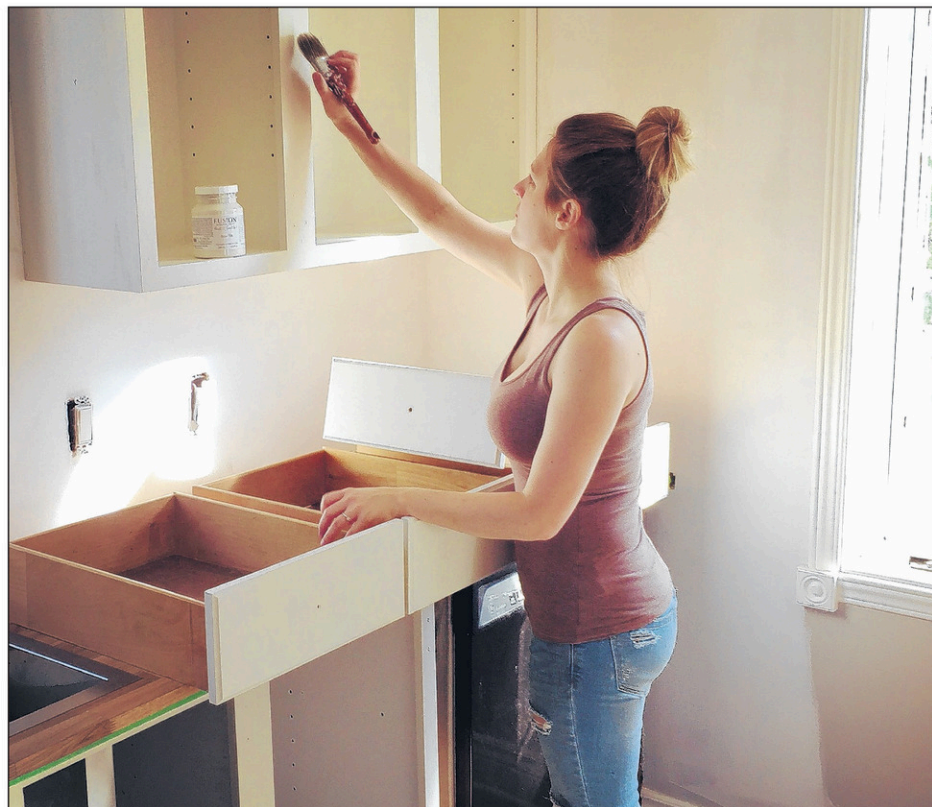
Le secret réside dans l'application de minces couches de peinture et dans le respect du temps de séchage entre chaque couche.
