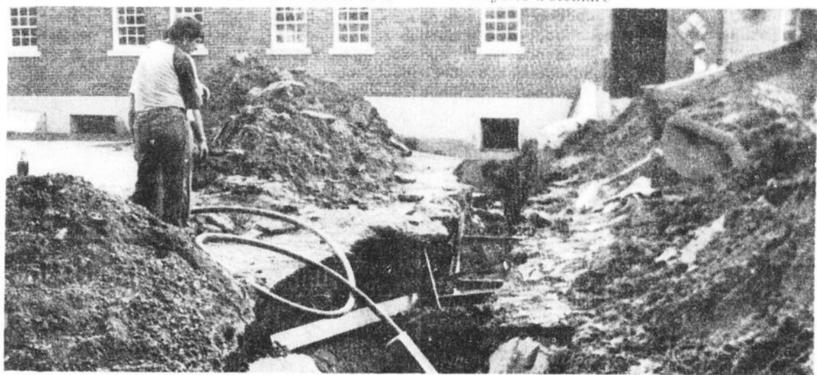
Une partie de cette tranchée s'est effondrée, blessant un travailleur, la semaine dernière, sur le terrain de la pépinière forestière de Berthier.
