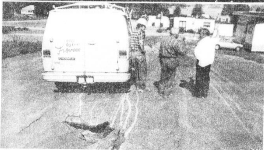
Le pavé a été troué, vendredi, lorsqu'un tuyau d'égout a éclaté, rue Provost. Les employés municipaux ont eu tôt fait de réparer le tout.
