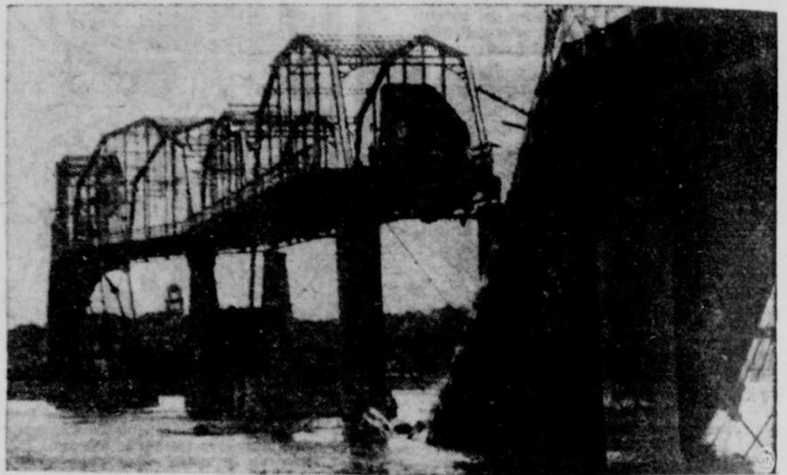
SITUATION PRECAIRE que celle du camion illustré, à demi suspendu dans le vide quand une travée de 160 pieds, faisant partie d'un pont du fleuve Mississippi à Muscatine, Iowa, s'est effondrée.
